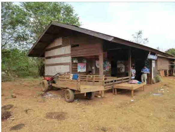
老朽化している既存施設。既存施設はそのまま、新保健センターは同敷地内に建設。 (サラワン県 S-01 Naxay 保健センター)
