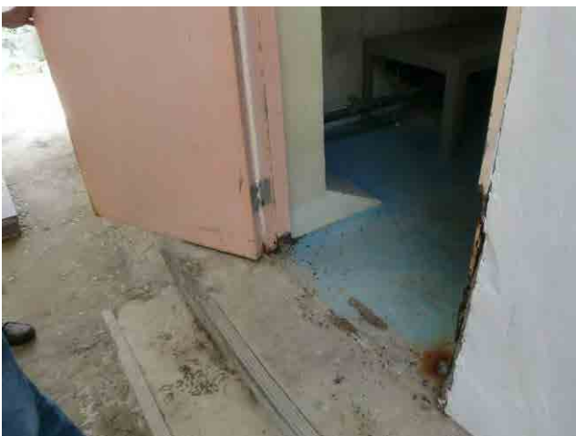
改修前 塩素注入室扉：設置後、適切に維持管理がなされていないため、腐蝕により劣化している。
