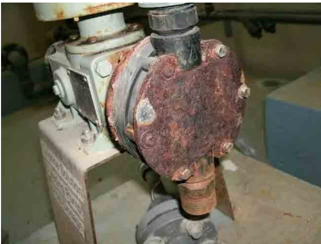
改修前 後塩素注入ポンプ：ダイヤフラム部が腐蝕により作動しなくなっている。後塩素の注入は行っていない。
