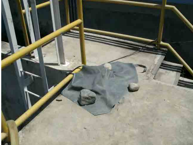
改修前 排水槽：シートの下にコンセントがある。雨除けのため、シートを被せている。
