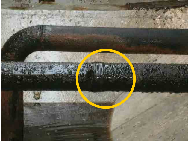
改修前 沈殿池：汚泥引抜管が腐蝕により穴が開いたため、ゴムシートで応急の修理を行っている。
