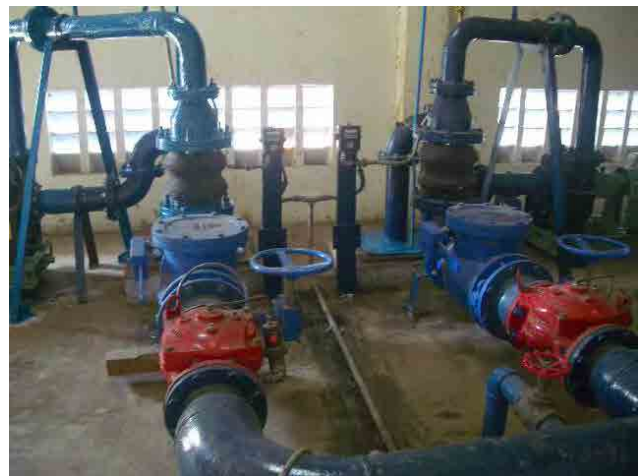
改修後 送・配水ポンプ：耐蝕製の陸上ポンプに更新され、今後錆等の懸念については解消された。
