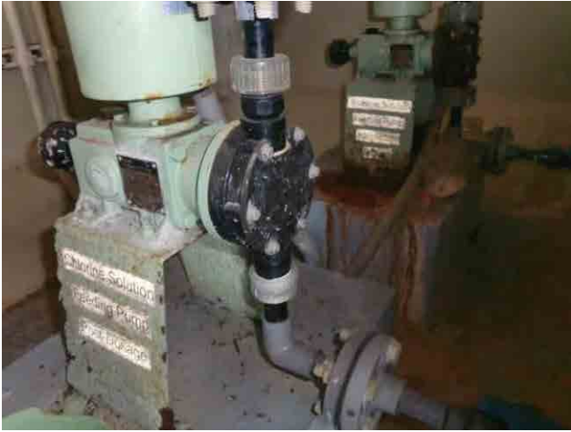
改修前 後塩素注入ポンプ：故障により使用できない。
