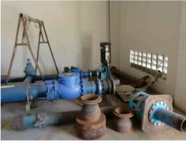
改修前 逆洗ポンプ：2009年10月頃に故障したため、ポンプを取り外した。
