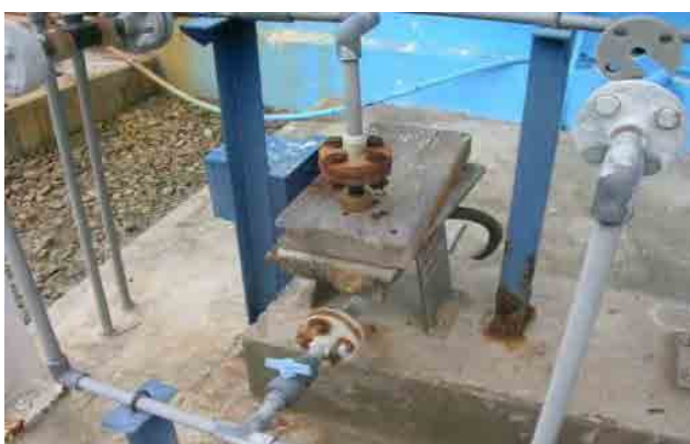
改修前 塩素注入ポンプ：腐蝕のため撤去されており、WD が仮設置した薬注ポンプが使用されているが、動力となる単相電源を隣接する配水ポンプ室より架空により取り出しているため、漏電等のリスクが高い。
