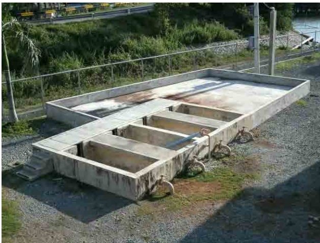
改修前 汚泥乾燥床：既存の汚泥乾燥床にWD側に新たに増設している。
