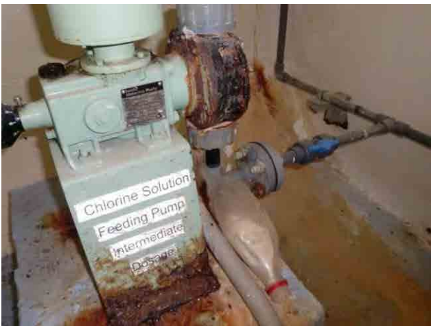
改修前 前・中間塩素注入ポンプ：ダイヤフラムより液漏れしている。
