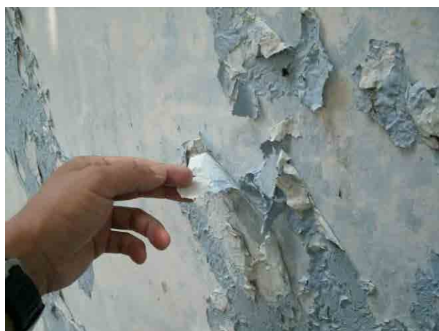
改修前 曝気塔：塗装が剥げてきているため、塗装の除去を WD が要望している。
