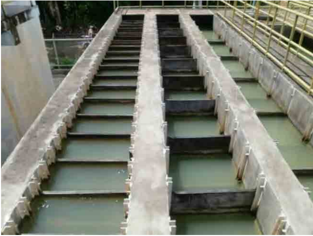
改修前 上下流式フロック形成池：う流板の調整が必要。
