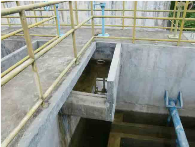
改修前 ろ過池：ろ過池に流入してくる微小フロックの破壊を防ぐため、流入構造の改良が必要。
