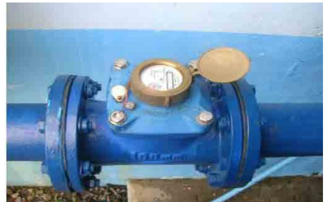
改修後 取水流量計：流量計を交換し、流量の把握が可能となった。
