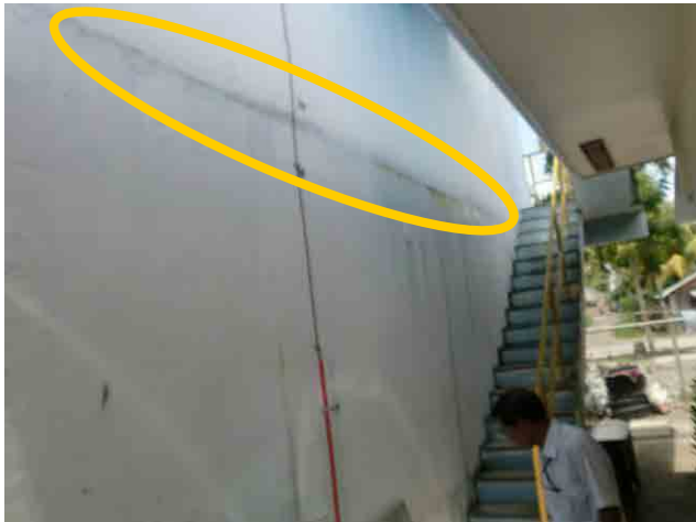
改修前 曝気塔：コンクリート打継部より漏水がみられる。
