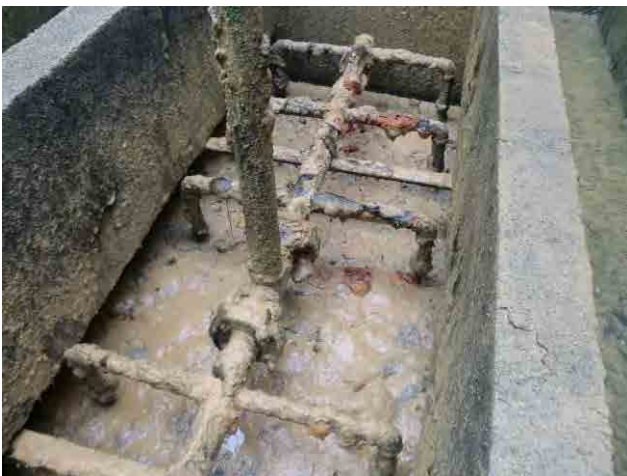
改修前 急速ろ過池表洗管：水を抜いた後のろ過池の様子。洗浄不足もあり、表洗管にフロック・汚泥の塊が付着している。
