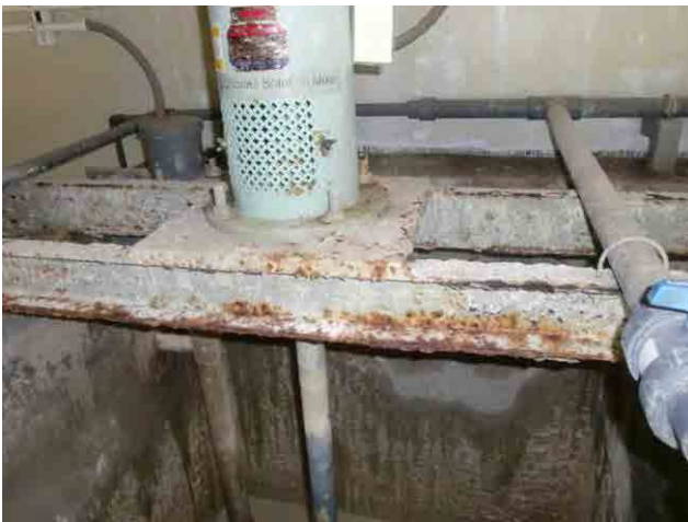
改修前 塩素攪拌機支持台：腐蝕による錆がみられる。
