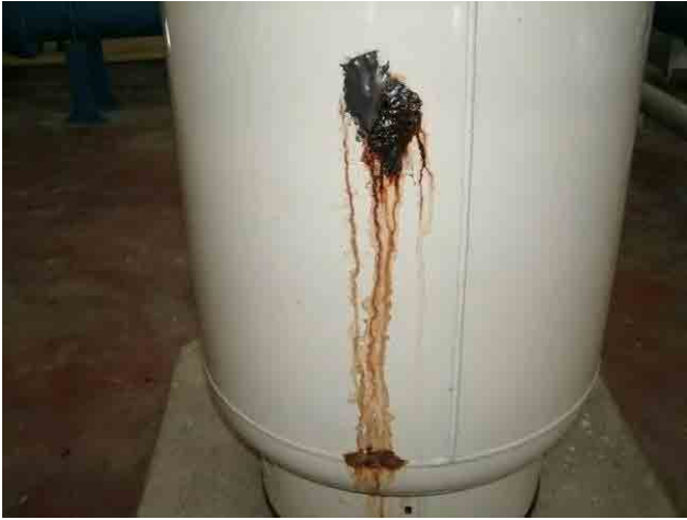
改修前 圧力タンク：腐蝕によるものか、外部に漏水跡があり、取り替えることが望ましい。
