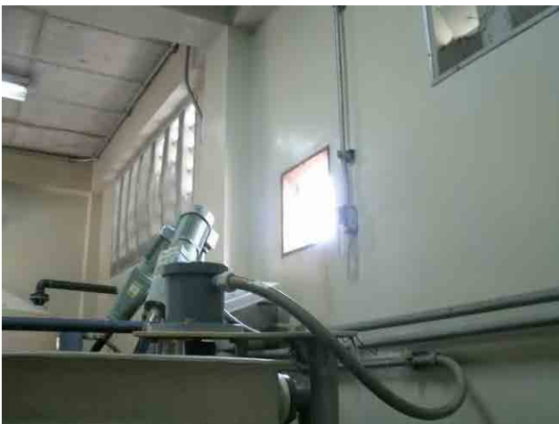
改修前 塩素室換気扇：故障により取り外されている。
