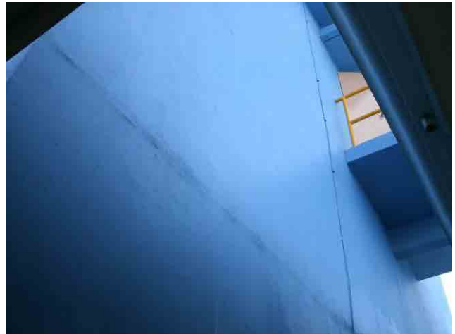
改修後 曝気塔：漏水部については補修されており、各施設の塗装も行われた。
