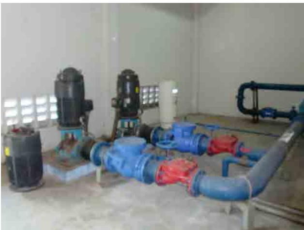
改修前 送・配水ポンプ：ポンプの錆瘤による老朽化が進行しており、急停止のリスクがある。
