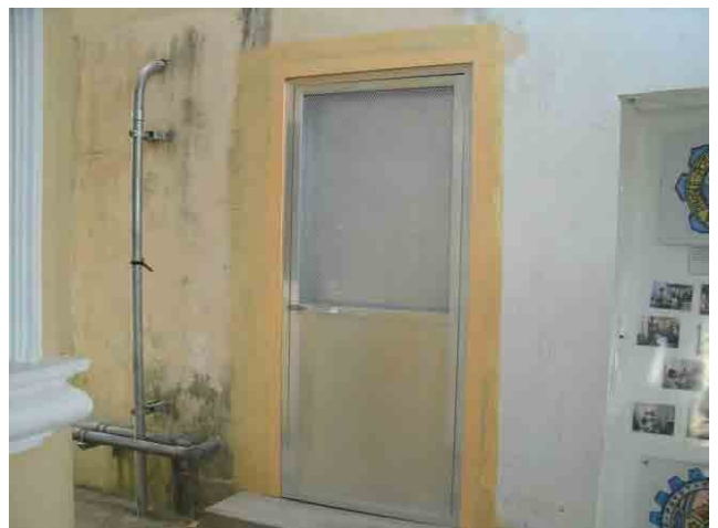
改修後 塩素注入室扉：アルミ製の2重扉に交換され、腐蝕の問題が無くなった。
