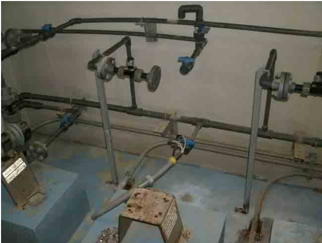
改修前 後塩素注入ポンプ：故障により取り除かれている。
