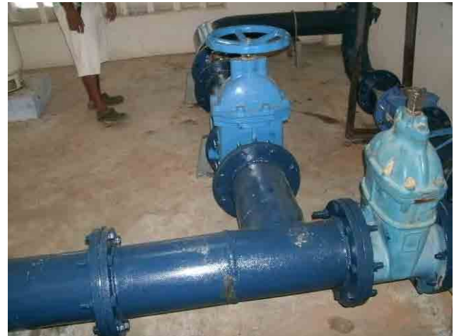
改修後 送水専用管：送水専用管が設置され、合わせて流量計の故障も交換により改善されたため、維持管理が容易になった。
