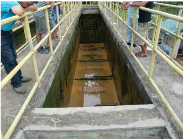
改修前 沈殿池汚泥引抜管：原水に塩分が含まれることより全ての配管で腐蝕が進行している。
