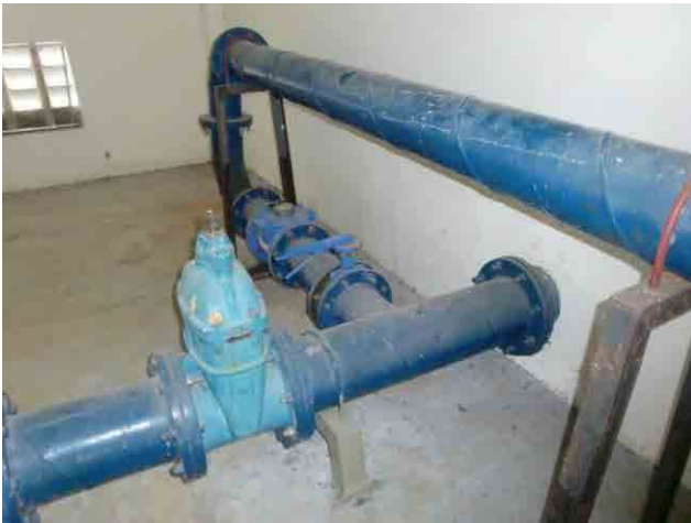
改修前 送水管：浄水池内の塩分濃度を薄めるために設けた他水源からの流入バイパス
