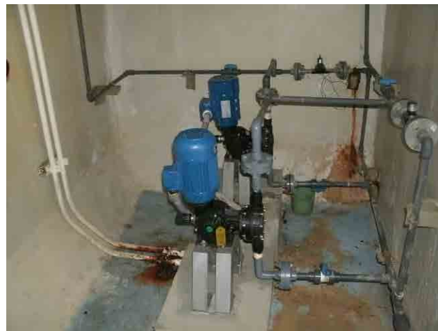
改修後 中間塩素注入ポンプ：ポンプが更新され、各注入管にバルブが設置され、均等に注入が可能となった。
