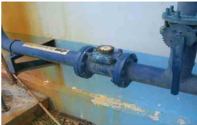
改修前 取水流量計：流量計が故障しており、流量の把握ができない。
