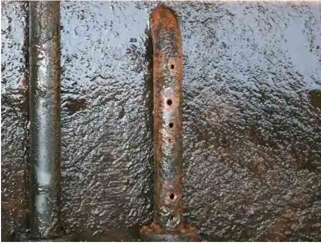
改修前 沈殿池：腐蝕により汚泥引抜管に穴が開いている。
