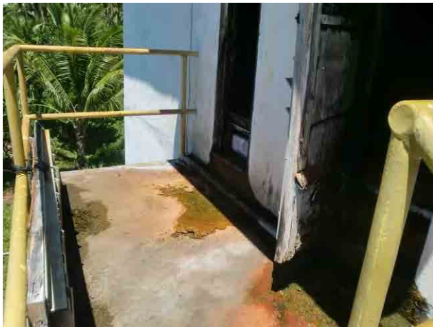
曝気塔：入口扉の老朽化が進行している。片方は扉が既に外されている。
