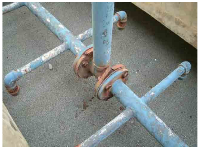
急速ろ過池：表洗管の錆が進行している箇所があるため、補修することが望ましい。
