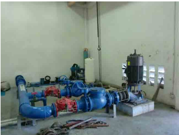
送水ポンプ：No.2ポンプについては、シャフトに問題があり、取り外している。モーターについては問題なし。現在はNo.1ポンプと表洗用ポンプを毎日交互運転している。
