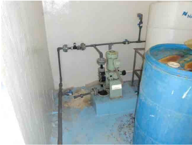
凝集剤注入ポンプ：故障により使用していない。
