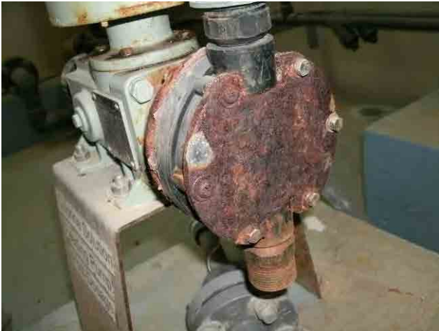
後塩素注入ポンプ：ダイヤフラム部が腐蝕により作動しなくなっている。後塩素の注入は行っていない。
