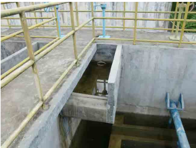
ろ過池：ろ過池に流入してくる微小ブロックの破壊を防ぐため、流入構造の改良が必要。
