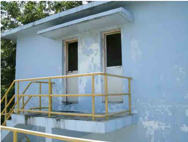
曝気塔：WDにより設置されたアルミ製ドア
