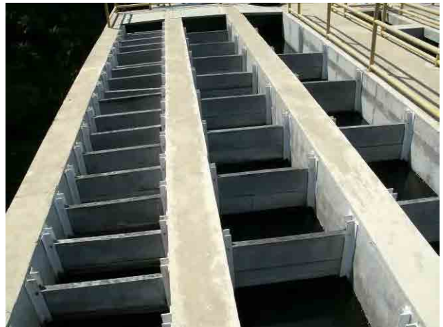
フロック形成池：阻流板の固定ネジが腐蝕により折れているものもあるため、板が落ちている箇所が見られる。
