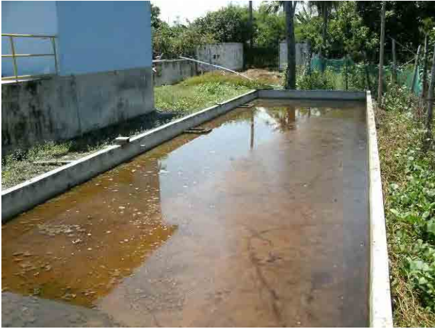
汚泥貯留槽：近影
