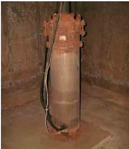
配水ポンプ：運転に支障はないが、錆が付いている。
