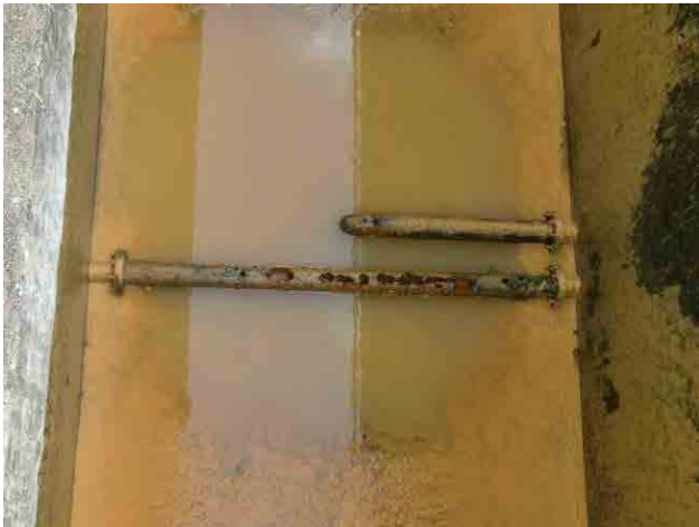
沈殿池汚泥引抜管：腐蝕により穴があいているになった配管。
