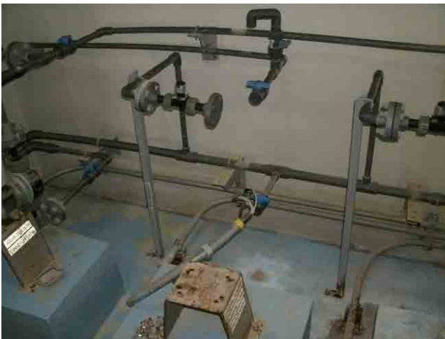
後塩素注入ポンプ：故障により取り除かれている。
