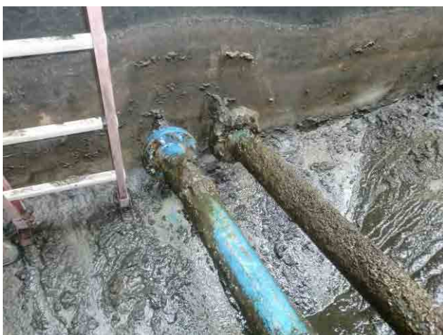
沈殿池汚泥引抜管：表面に汚泥が付着しているものの、配管自体は腐蝕していない。
