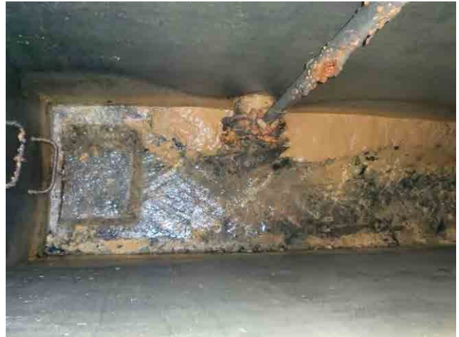
沈殿池流入弁：腐蝕の進行により錆瘤が付着している。
