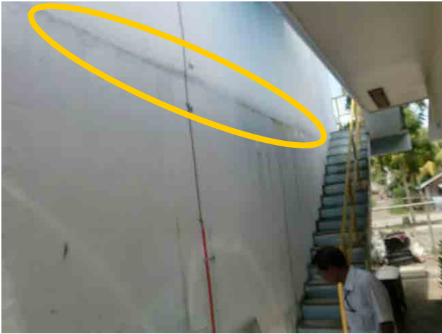
曝気塔：コンクリート打継部より漏水がみられる。
