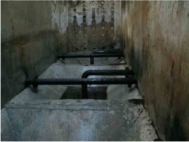
沈殿池：汚泥引抜管の塗装が剥げてきており、腐蝕が進行しているものがある。
