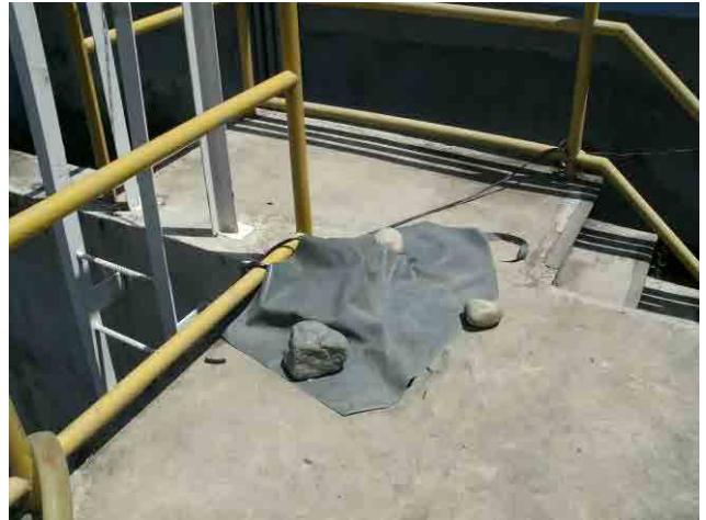
排水槽：シートの下にコンセントがある。雨除けのため、シートを被せている。
