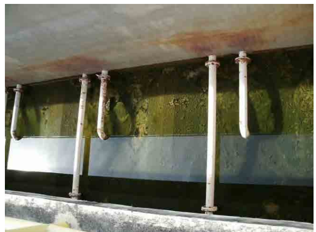
沈殿池：錆が付いている配管があるため、再度防水塗装することが望ましい。
