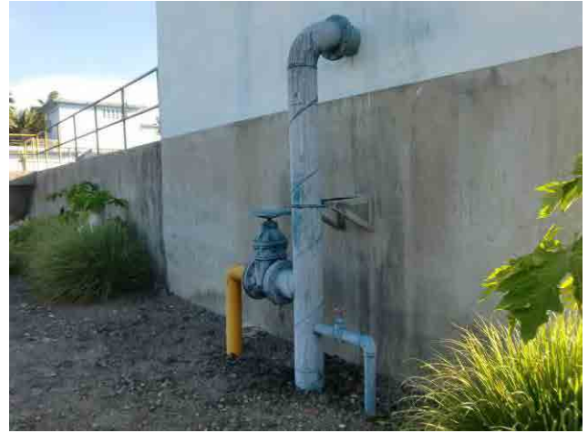
急速ろ過池表洗管：表洗管を送水管に繋ぎ込んで、表洗ポンプを送水用に使っている。そのため、ろ過池の表面洗浄を行っておらず、マッドボールの形成に繋がっている。
