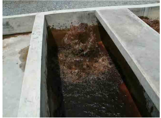
汚泥乾燥床：褐色の汚泥引抜水が流入する様子。
