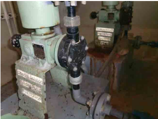
後塩素注入ポンプ：故障により使用できない。
