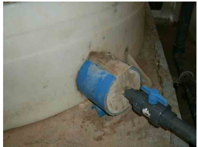
塩素タンク：配管接続部より塩素溶液の漏出が生じていたため、WD側で補修を行った。
