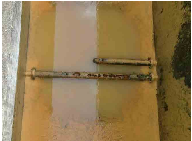
沈殿池汚泥引抜管：腐蝕により穴があいているになった配管。
