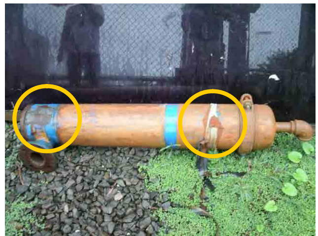
除砂器：穴が開いたため、補修して使用していたが、使用できなくなったため撤去した除砂器。
