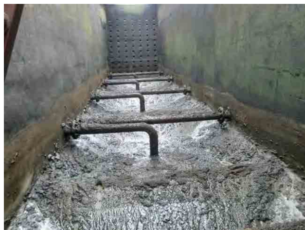
沈殿池：マンガンのためか黒い汚泥である。
