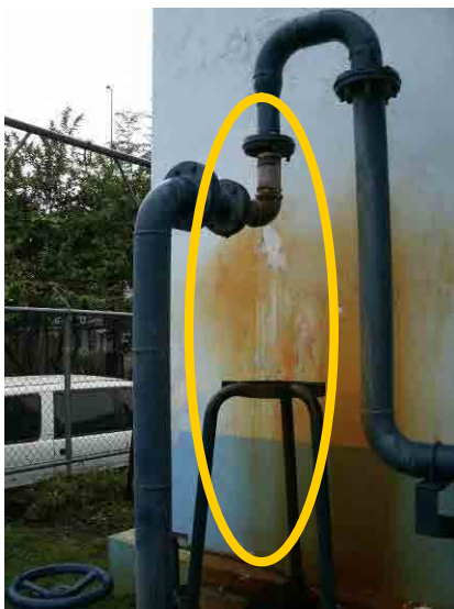
除砂器：2回交換したが、穴が開いたため取り外した。
