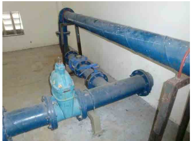
送水管パイパス：浄水池内の塩分濃度を薄めるために設けた他水源からの流入パイパス
