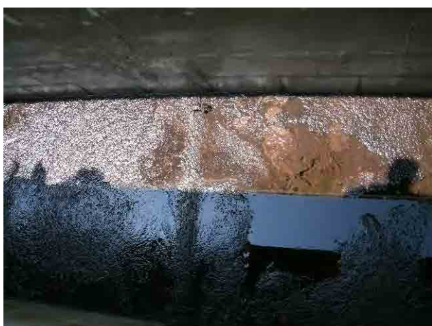
沈殿池：褐色の汚泥が多量に沈殿池に堆積している。
