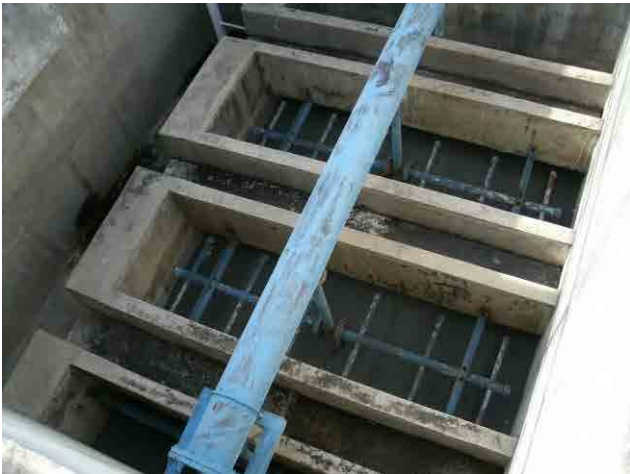
急速ろ過池：表洗管の錆が進行している箇所があるため、補修することが望ましい。
