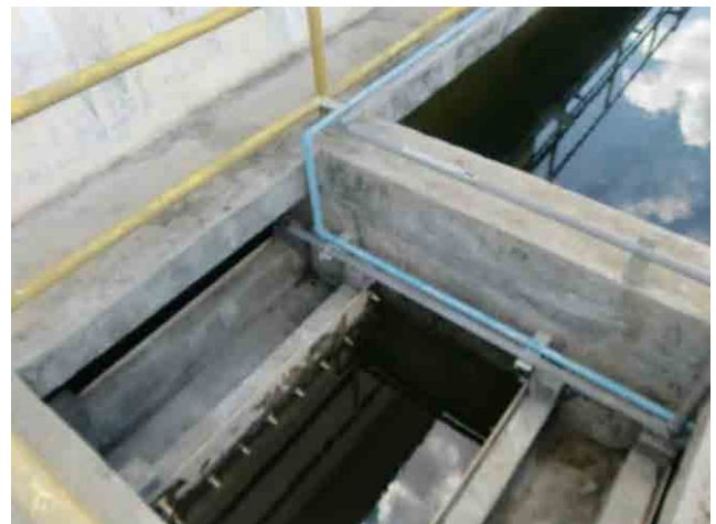
中間塩素注入配管：塩素が均等に注入できないため、改良が必要。
