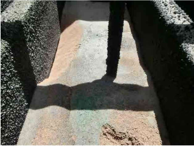
急速ろ過池：計画では砂層厚は60cmであるが、現在90cmもあるため、表洗管が埋もれており、またトラフ下に隙間がないため、ろ過面積も減少している。
