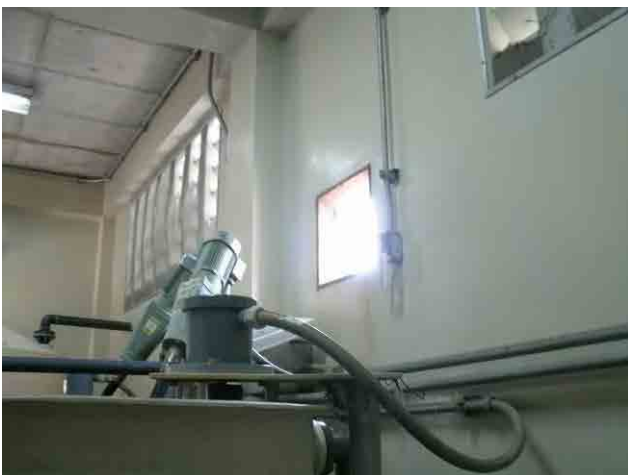
塩素室換気扇：故障により取り外されている。
