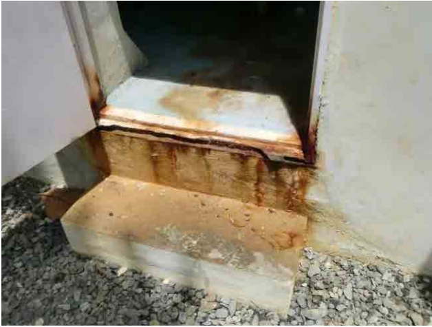
塩素注入室扉：腐蝕によりボロボロになっている。
