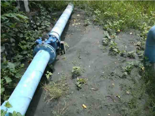
No.7 井戸：砂の巻上げが多い。
