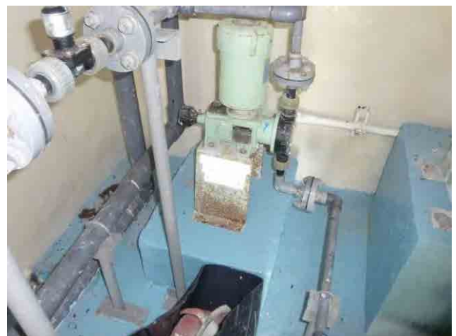
後塩素注入ポンプ：電源を入れても動かず故障している。
