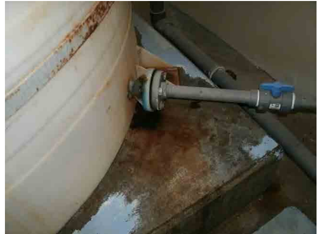
塩素タンク：配管接続部より塩素溶液が漏出している。
