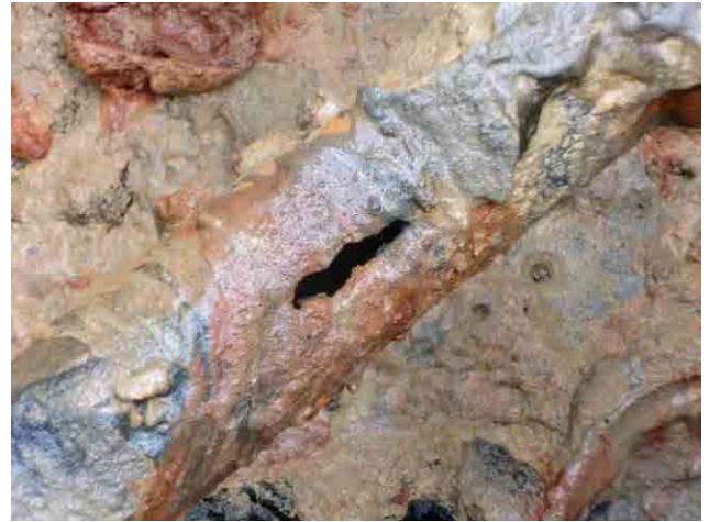
急速ろ過池表洗管：フロックの塊との間での腐蝕が進行したためか、表洗管に穴が開いている。
