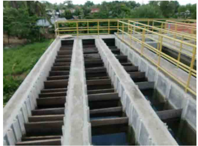
上下流式ブロック形成池：う流板の調整が必要。
