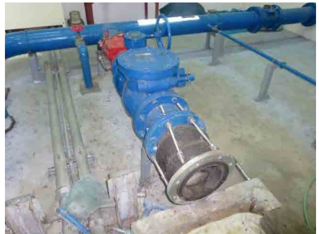
送水ポンプ：No.2送水ポンプについては故障により取り外している。
