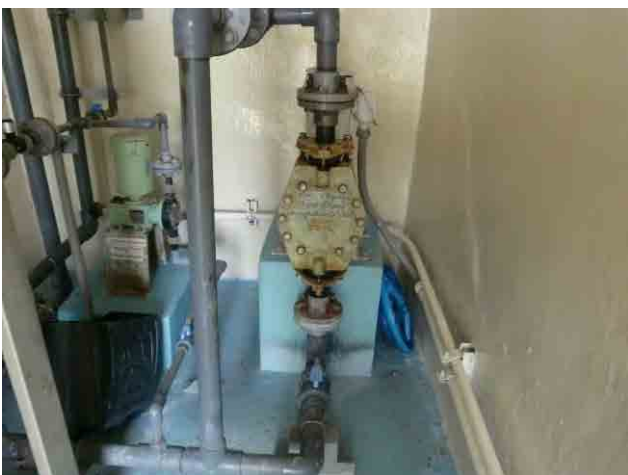
中間塩素注入ポンプ：しばしば故障により停止するものの、分解して修理をしているので、何とか使用できている。
