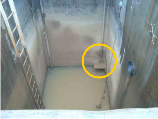
排水槽：回収ポンプは故障したため、撤去した。
