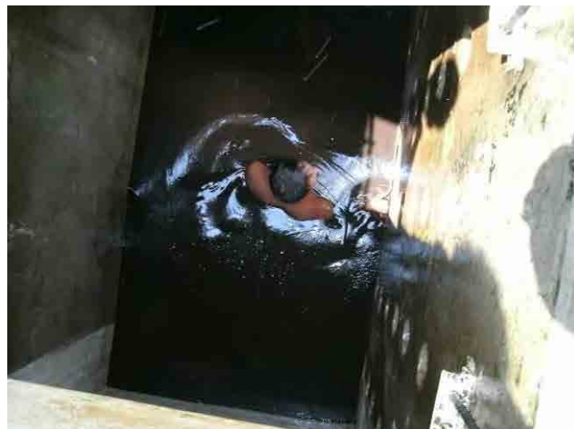
沈殿池：流出側にも汚泥が堆積している。
