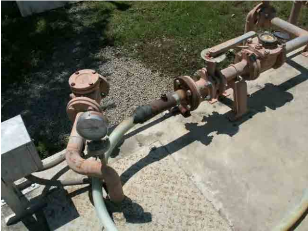
排水槽：当初設置の回収ポンプの故障により、WD 側で単相のポンプを購入し、既存配管と接続している。
