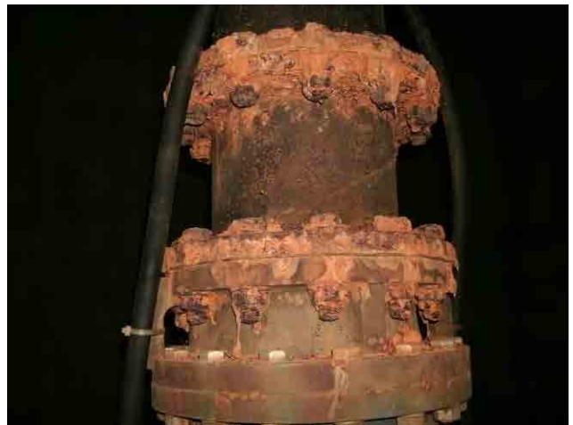
逆洗ポンプ：運転に支障はないが、錆が付いている。
