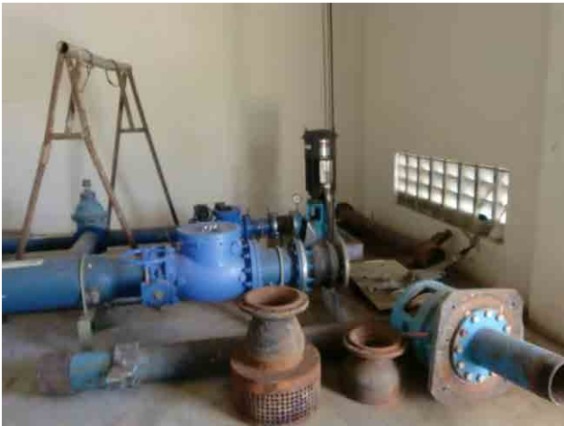
逆洗ポンプ：2009年10月頃に故障したため、ポンプを取り外した。
