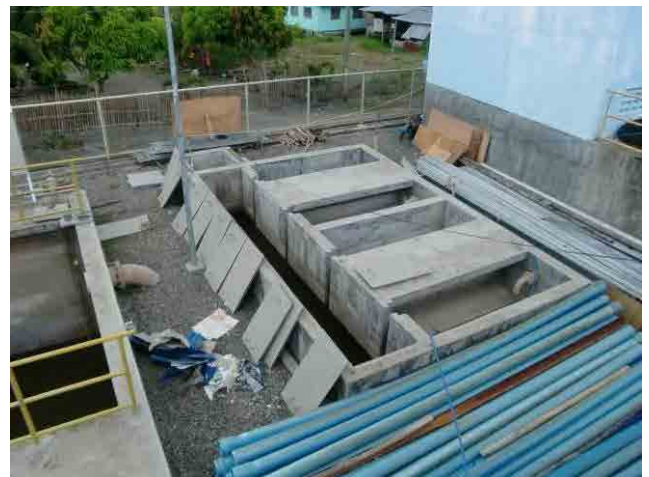
汚泥乾燥床：比国排水基準の変更に伴い、汚泥乾燥床としての機能を持たせるため、砂利等を充填する。
