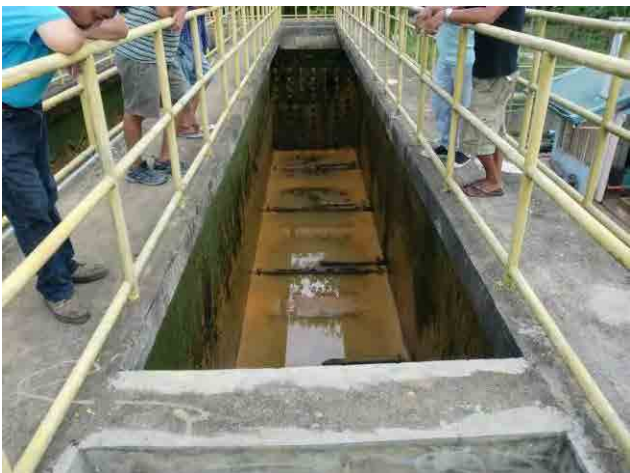
沈殿池汚泥引抜管：原水に塩分が含まれることより全ての配管で腐蝕が進行している。
