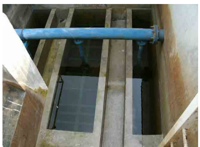
ろ過池：逆洗のみであるが、洗浄した後は比較的クリアな状況である。
