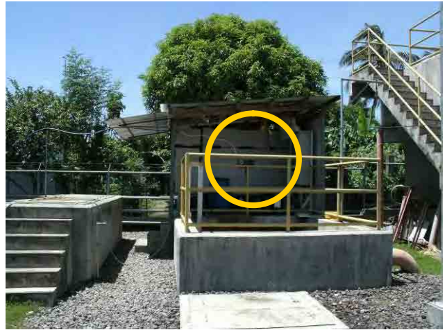
塩素注入ポンプ：WD が設置した塩素注入ポンプ。
