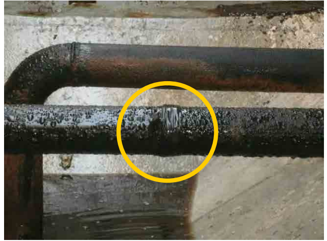
沈殿池：汚泥引抜管が腐蝕により穴が開いたため、ゴムシートで応急の修理を行っている。
