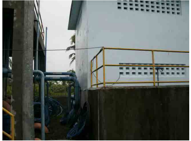
塩素注入ポンプ：単相電源であるため、ポンプ室より延長コードを伸ばして電源を確保している。
