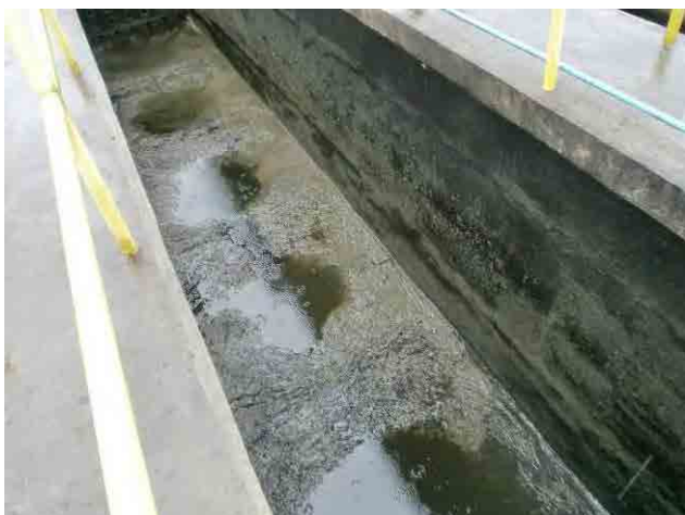
沈殿池：堆積汚泥については、運転開始後 3 回程しか除去していない。そのため、汚泥がかなり蓄積している。
