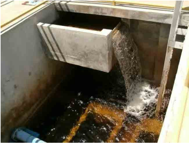
ろ過池：ろ過池に流入してくる微小フロックの破壊を防ぐため、流入構造の改良が必要。
