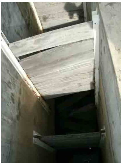
フロック形成池：う流板固定用ネジが腐蝕のため折れているものもあり、板が脱落している箇所がみられる。
