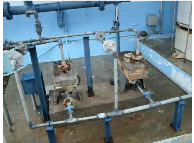
塩素注入ポンプ：屋外設置のためか、腐蝕が進行し撤去した。
