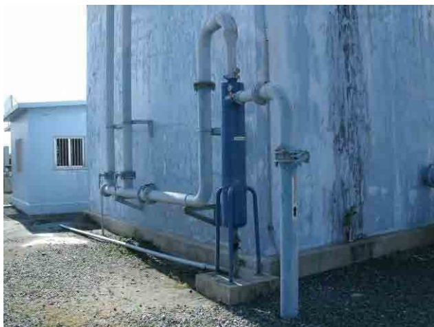
除砂器：井戸から砂が流出している。
