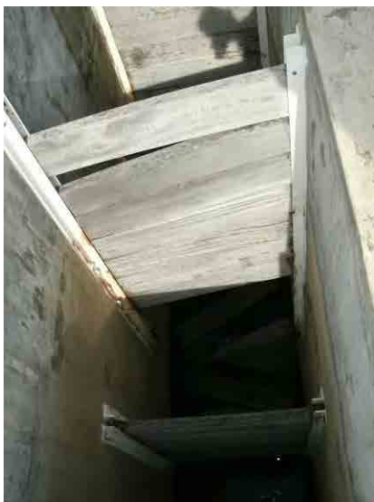
ブロック形成池：う流板固定用ネジが腐蝕のため折れているものもあり、板が脱落している箇所がみられる。
