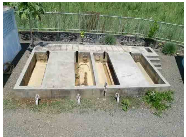
汚泥乾燥床：比国排水基準の変更に伴い、汚泥乾燥床としての機能を持たせるため、砂利等を充填する必要がある。
