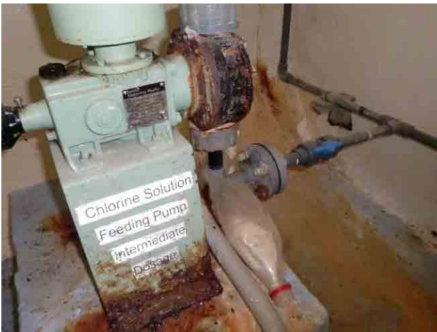
前・中間塩素注入ポンプ：ダイヤフラムより液漏れしている。
