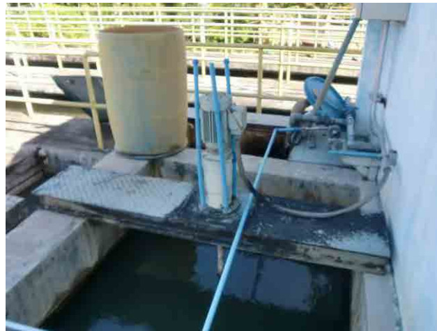
急速攪拌機：現在故障している。雨が当たらないようにポールを立ててカバーをしていた。一度分解してグリースを塗るなどしてメンテナンスをしていた。
