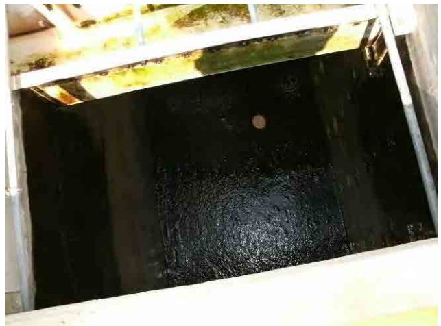
沈殿池：流出側に汚泥が堆積している状況である。フロックの沈降が十分でないことが原因と考えられる。
