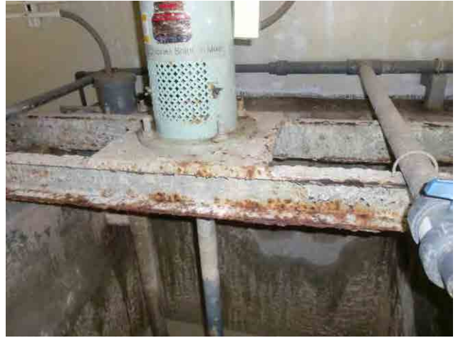
塩素攪拌機支持台：腐蝕による錆がみられる。
