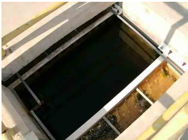
沈殿池：フロックが流出トラフからキャリーオーバーしている。
