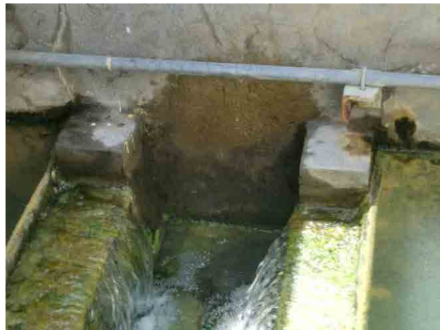
中間塩素注入配管：塩素が均等に注入できないため改良が必要。
