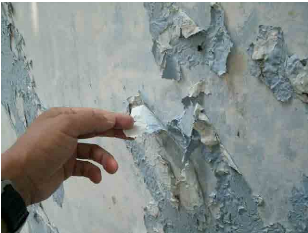
曝気塔：塗装が剥げてきているため、はつることをWDが要望している。
