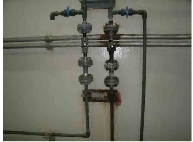
前・中間塩素注入管：一部配管が腐蝕により劣化している。
