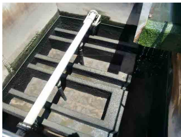
急速ろ過池：ろ過砂が必要以上に投入されており、砂の除去が必要である。
