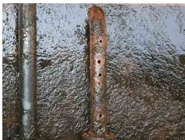
沈殿池：腐蝕により汚泥引抜管に穴が開いている。
