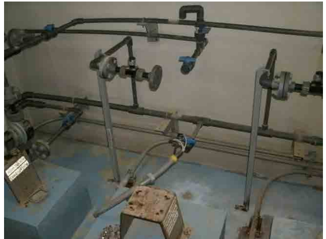
後塩素注入ポンプ：故障により取り除かれている。
