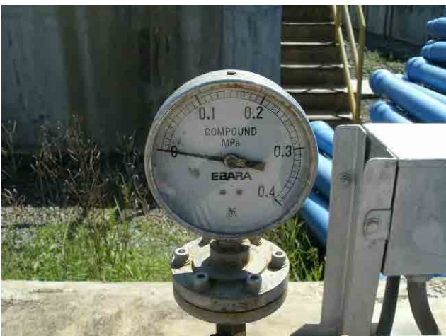
回収ポンプ用圧力計：作動しない。
