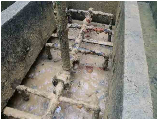
急速ろ過池表洗管：水を抜いた後のろ過池の様子。洗浄不足もあり、表洗管にフロック・汚泥の塊が付着している。
