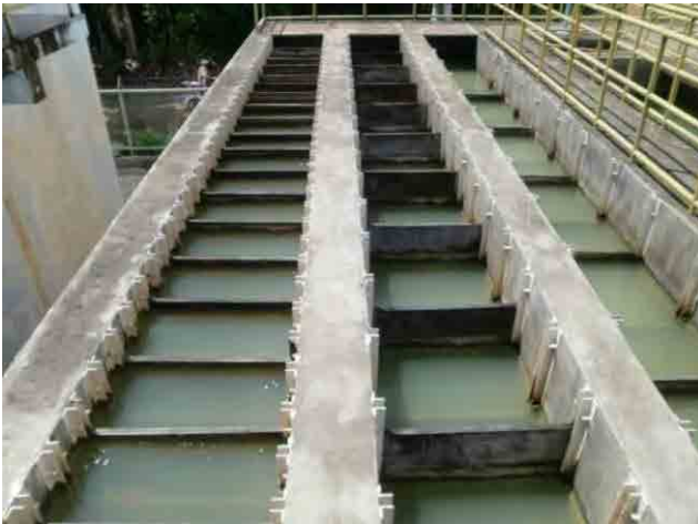
上下ろ流式フロック形成池：う流板の調整が必要。
