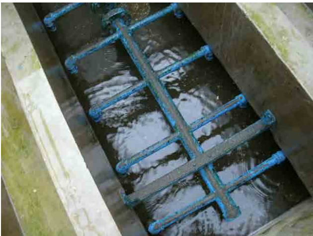
ろ過池：ろ過池洗浄中。
