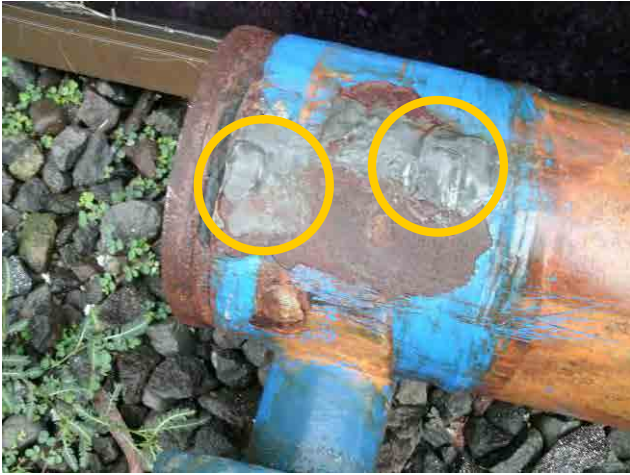
除砂器：パテで穴を塞いだ補修跡。
