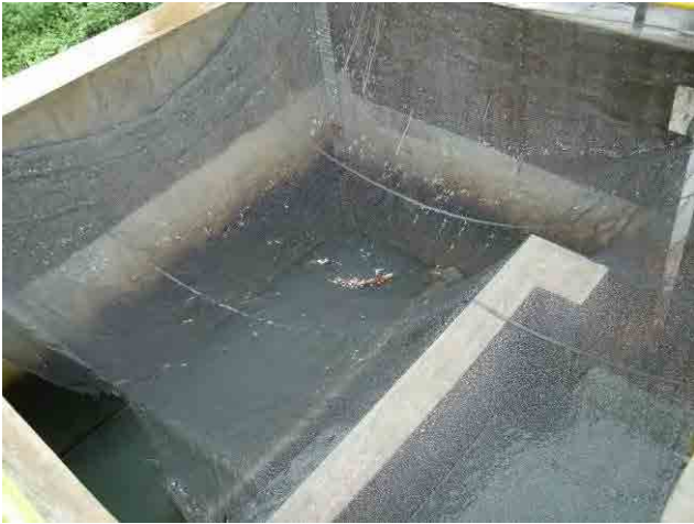
ろ過池：落ち葉の流入を防ぐため、ネットを被せている。
