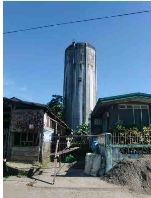
高架水槽：WD 事務所前にある高架水槽
