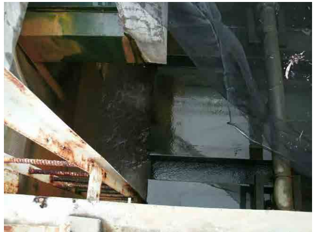
ろ過池：逆洗後。
