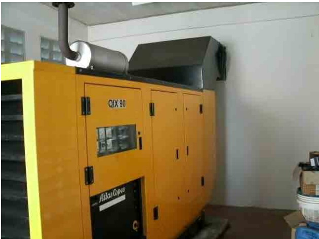
自家発電機：維持管理が大変良好であり、新品同様の状態である。
