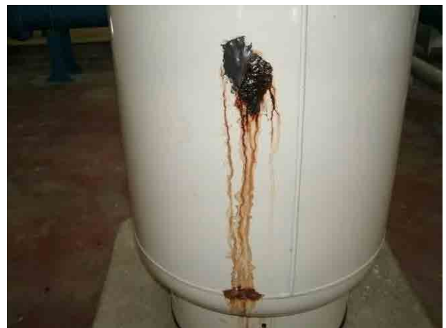
圧力タンク：腐蝕によるものか、外部に漏水跡があり、取り替えることが望ましい。
