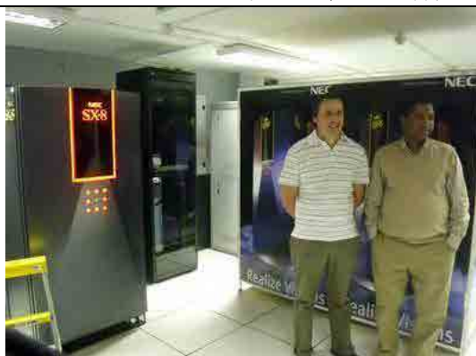
SAWS のコンピュータールーム
