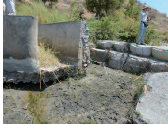
ラクロ川の河床低下により取水不可となった水路
