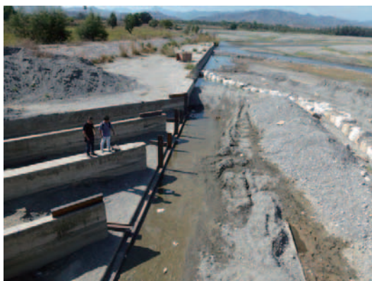
ラクロ川からの取水部分に砂礫が堆積している(取水工前部の鋼材は砂礫防止のためのゲート工事の実施途中)
