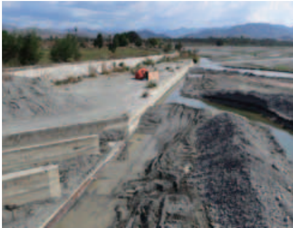
ラクロ灌漑地区への取水口
