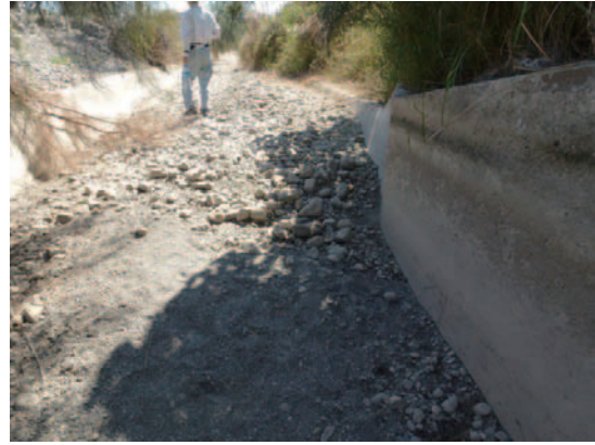
水路内に流入し堆積した砂礫
