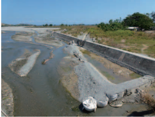
サウ地区の取水口部分、土のうにより砂礫流入防止
