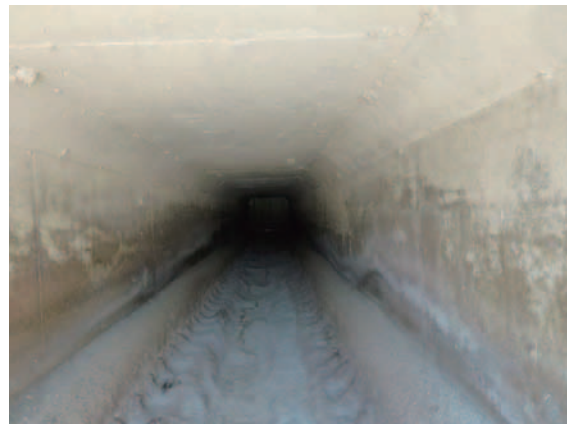
同左 暗渠部分、砂礫により摩耗損傷している
