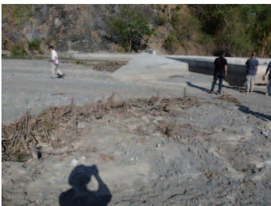
レインボール地区の洗掘により傾いた取水施設
