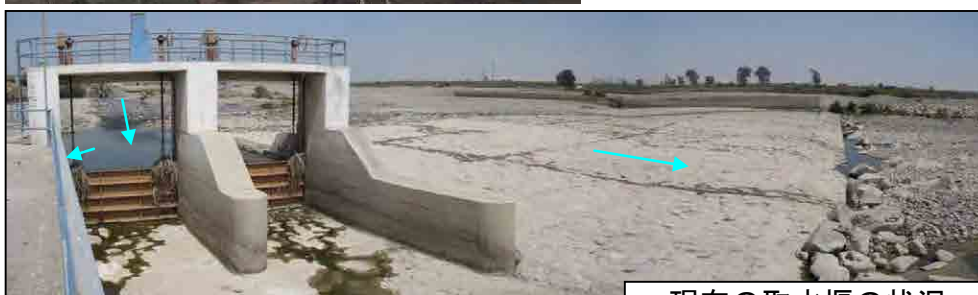
現在の取水堰の状況
