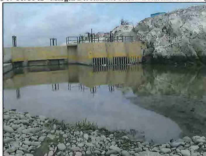
FOTO N° 36: Pi-02 - Margen Derecha Río Pisco – Bocatoma Caucato (6+740)
