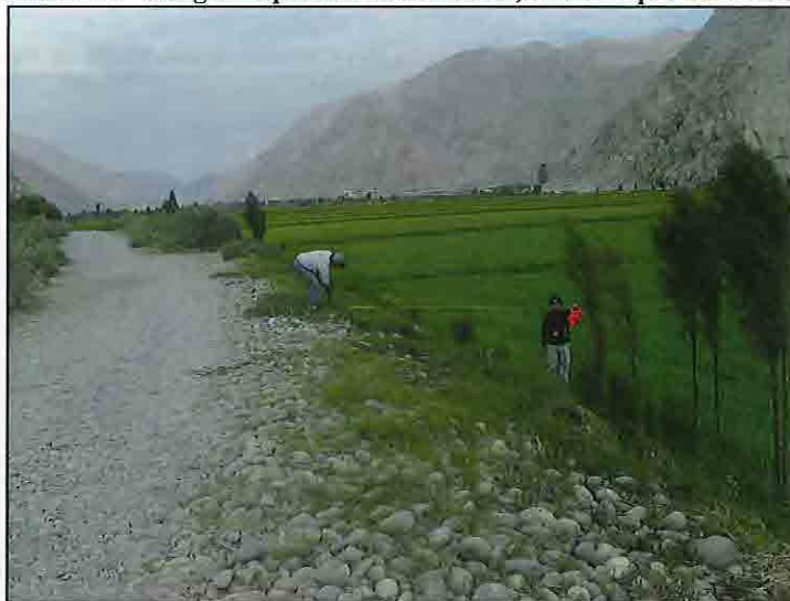
FOTO N° 50: MC-02 - Margen Izquierda Río Camaná, Dique erosionado (9+300)
