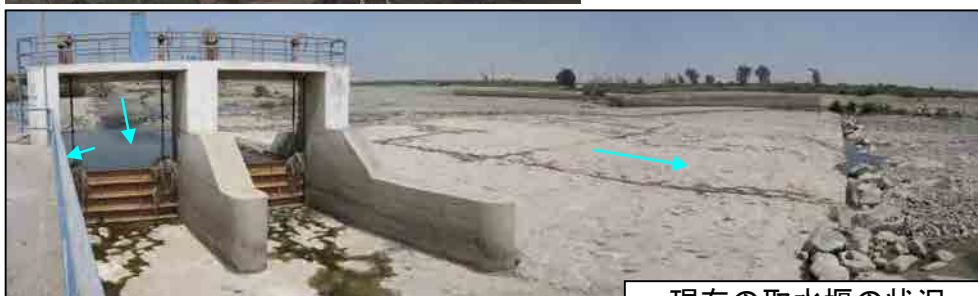
現在の取水堰の状況
