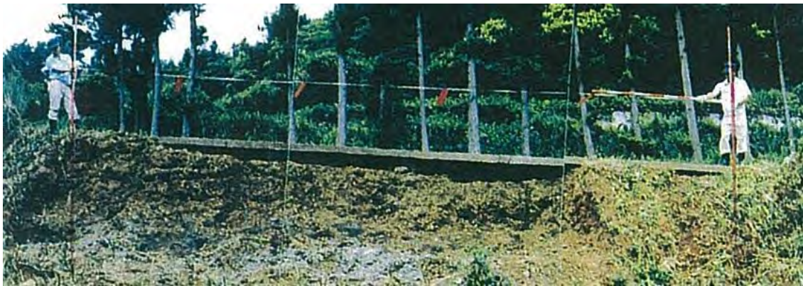
ภาพถ่ายที่ 2.2.1 ตัวอย่างการตรวจวัดแนวเส้นทางที่ได้รับความเสียหายด้วยโพล, เทปวัดระยะ (ผูกด้วยผ้าสีแดง)
