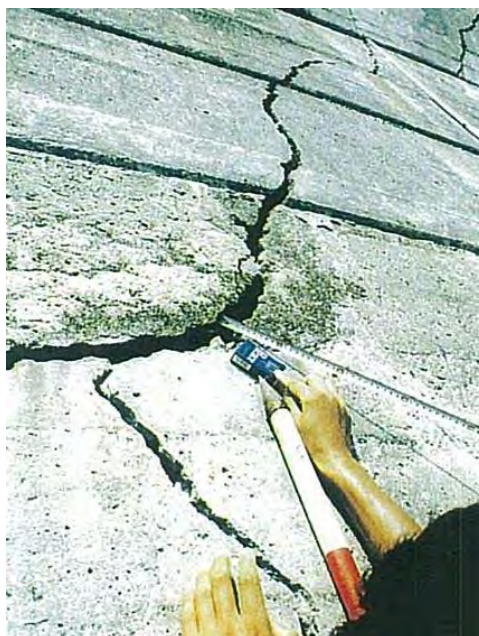
ภาพถ่ายที่ 2.2.16 การตรวจวัดรอยแตกของกำแพงกันดินคอนกรีต
