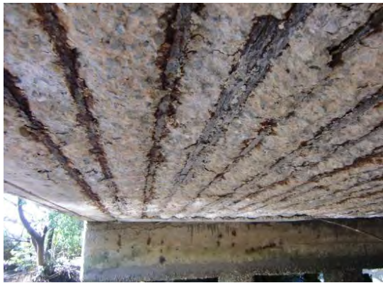
มีเหล็กเสริมเป็นสนิมในบริเวณกว้าง
