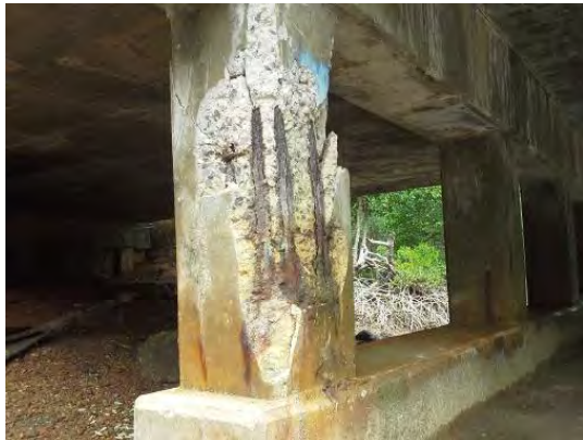
มีการ โผล่ของเหล็กเสริมบริเวณรอบเสาตอม่อ
