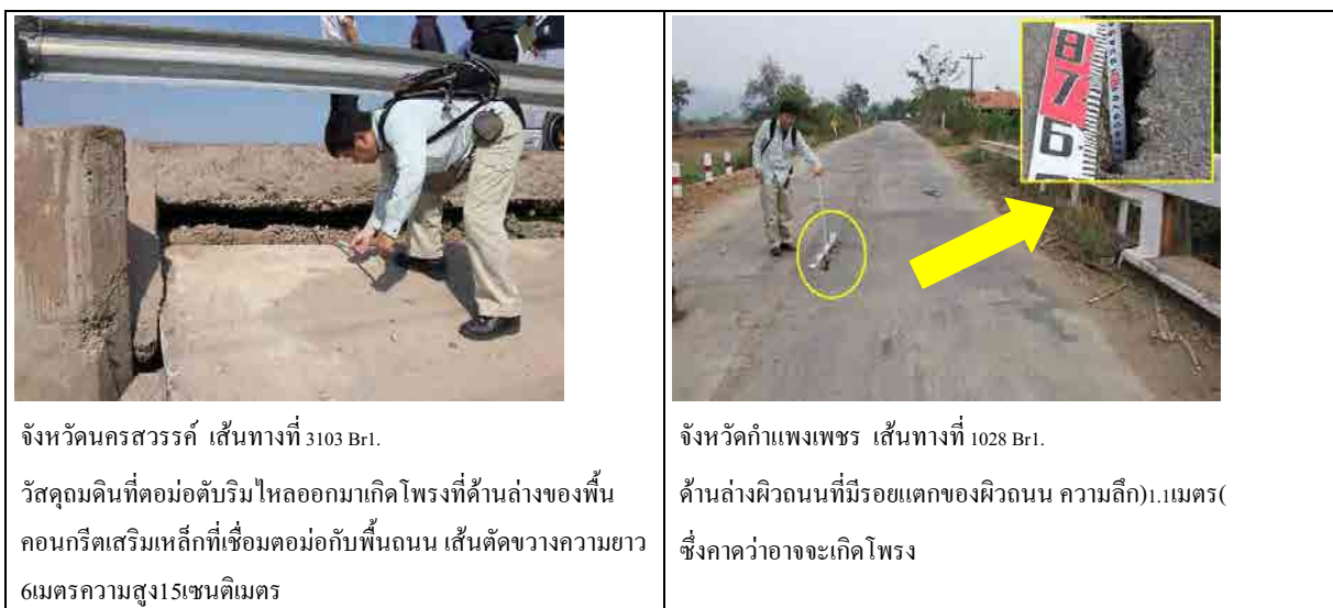
รูปถ่าย 7.3-3 การเกิดการทรุดตัวของผิวถนน การเกิดรอยแตกและโพรง
