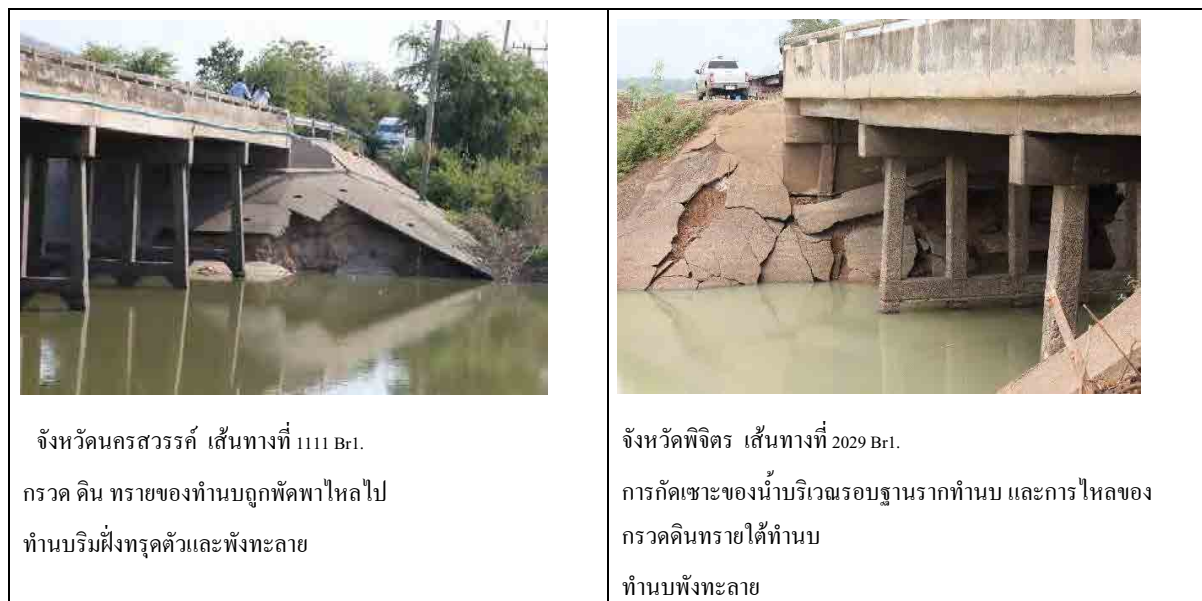
รูปถ่าย 7.3-2 .การทรุดตัวและพังทะลายของกำแพงตลิ่งริมฝั่งบริเวณรอบตอม่อ
