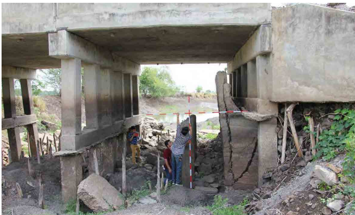
รูปภาพ 8.1-5 สภาพการวัดการกัดเซาะของพื้นที่ตอม่อริมสะพานที่มีอยู่เดิม, เสาตอม่อที่สร้างเหลือไว้
