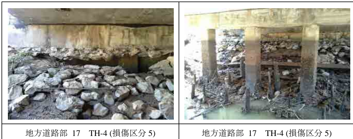
図 5.2-5 損傷事例 (護岸工)
