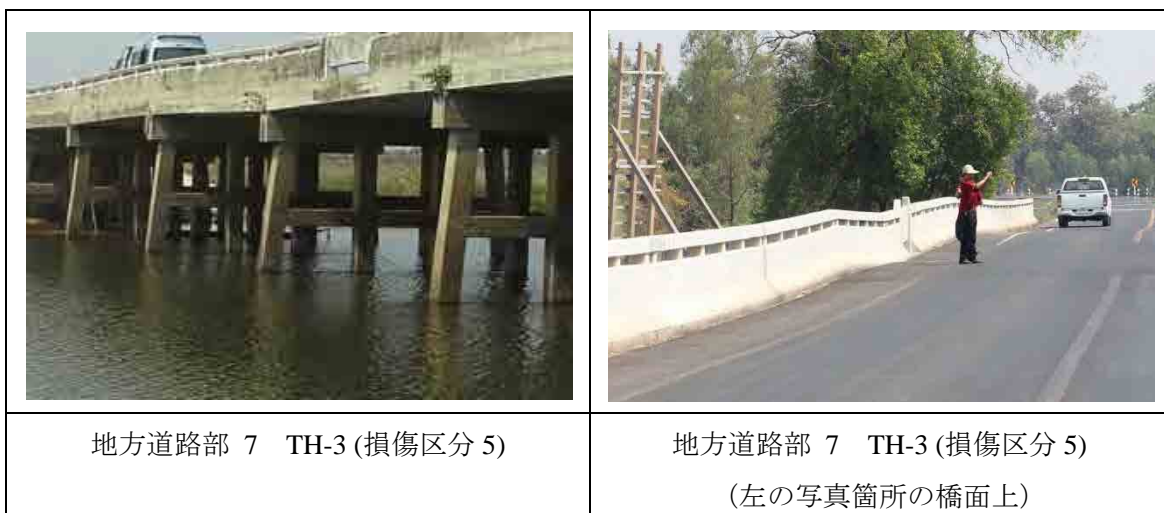
図 5.2-7 損傷事例 (沈下)
