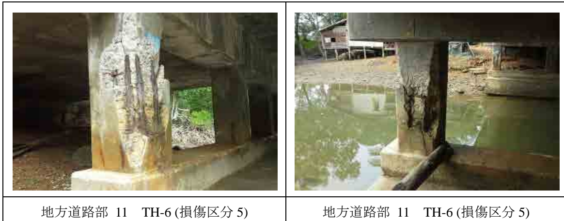
図 5.2-6 損傷事例 (塩害)
