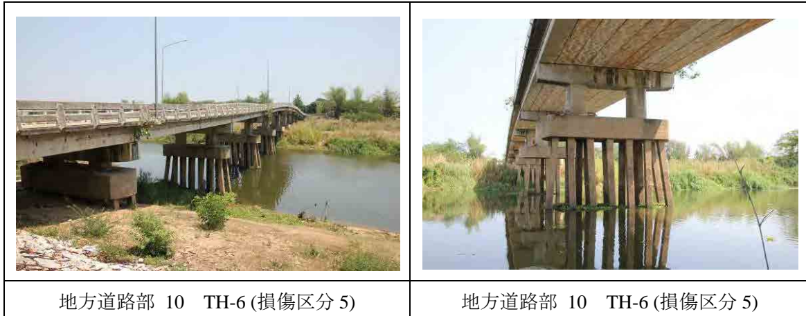
図 5.2-4 損傷事例 (洗掘)
