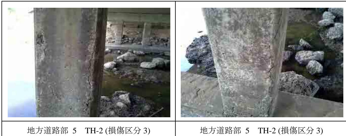
図 5.2-2 損傷事例 (ひびわれ)
