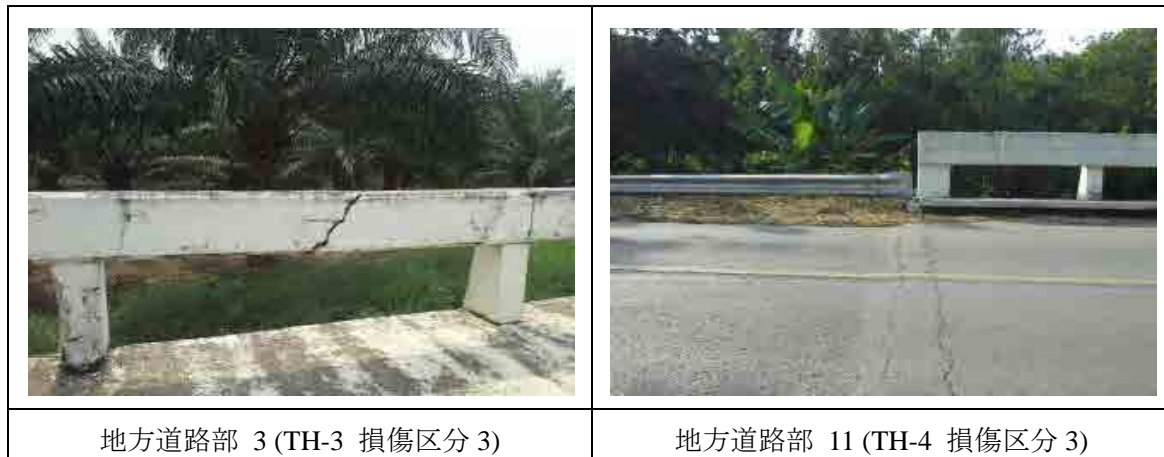
図 5.2-8 損傷事例（橋面上）
