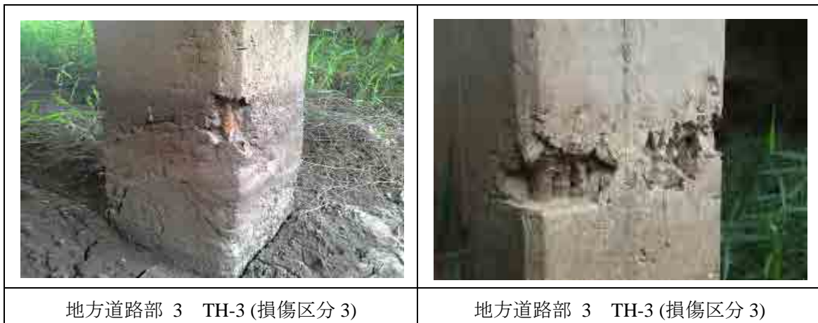
図 5.2-3 損傷事例 (鉄筋露出)
