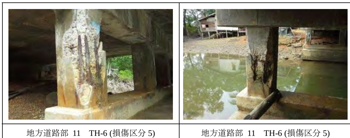
図 2.2-1 パイロット橋梁の点検における損傷事例（塩害）
