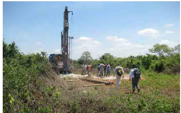
井戸掘削の様子。2 本の井戸からの給水を合せて計画施設に必要な給水を賄う。
