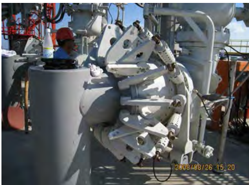
Photo- 16: LNG unloading arm coupler
