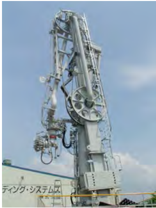
Photo- 14: LNG unloading arm
