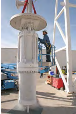
Photo- 38: LNG pump (pot type)
