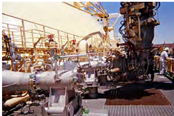
Photo- 17: LNG unloading arm
