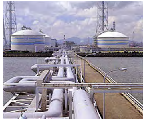
Photo- 2: LNG incoming piping
