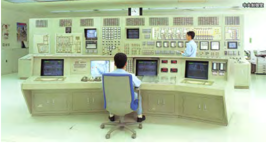
Photo- 55: LNG base central control room
