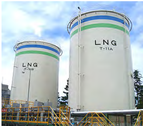
Photo- 26: LNG tank for satellite base
