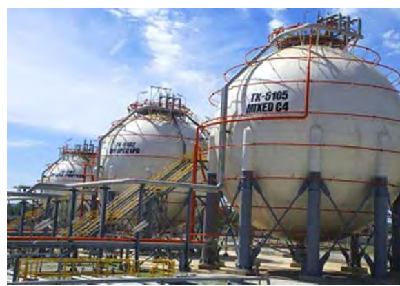
Photo- 29: LPG tank (Zung Quat)
