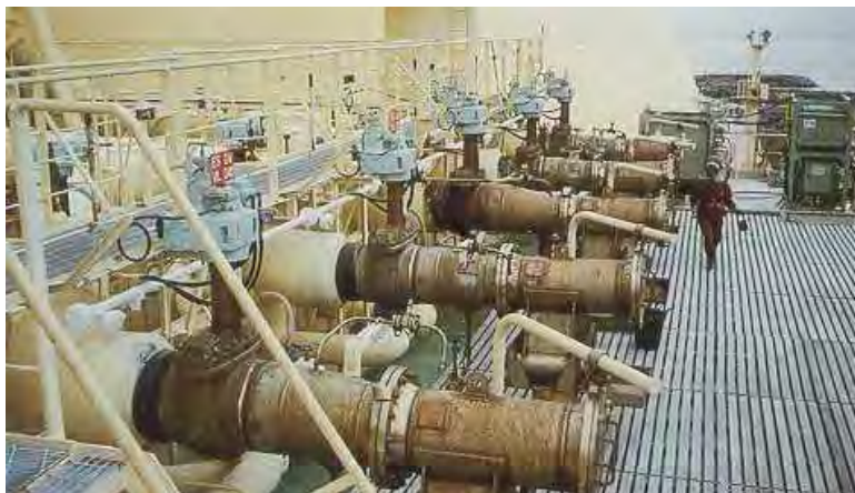
Photo- 20: LNG shutoff valve
