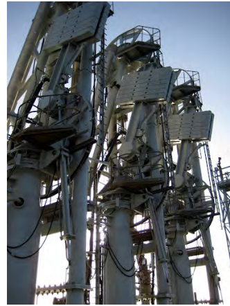
Photo- 15: LNG unloading arm
