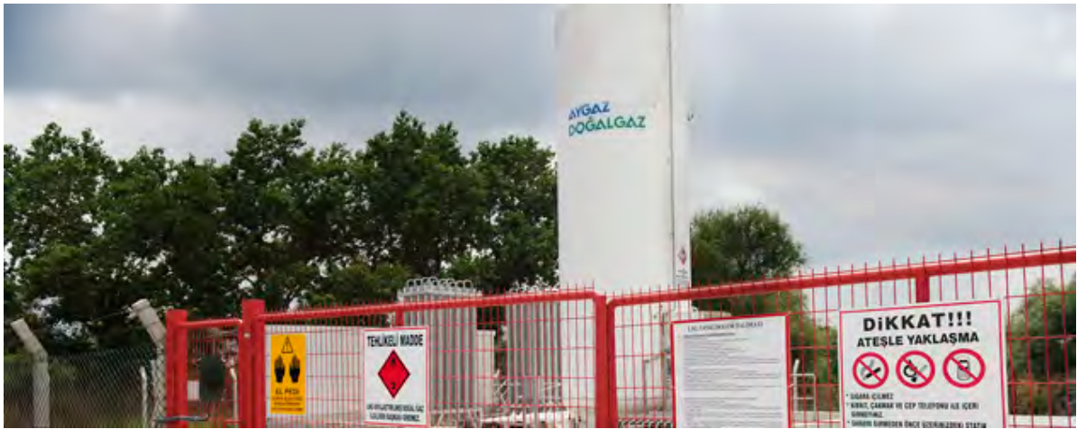
Photo- 32: Warning signs for LNG base
