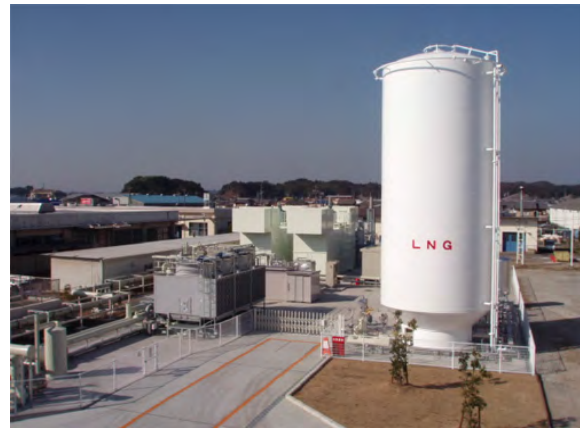
Photo- 27: LNG tank for satellite base
