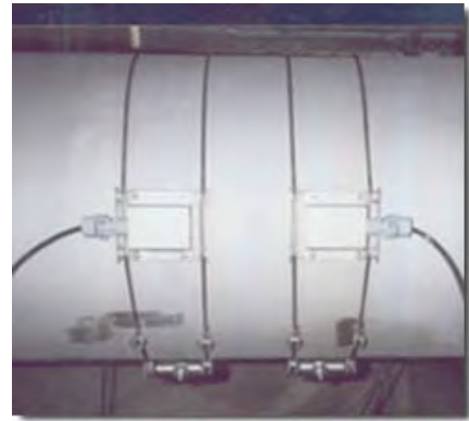
Photo- 35: Sensor for LNG tank piping
