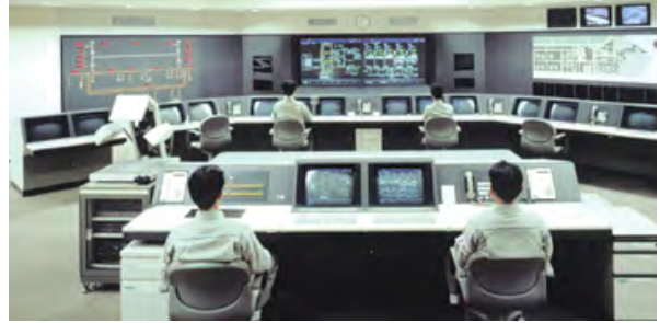
Photo- 56: LNG base central control room
