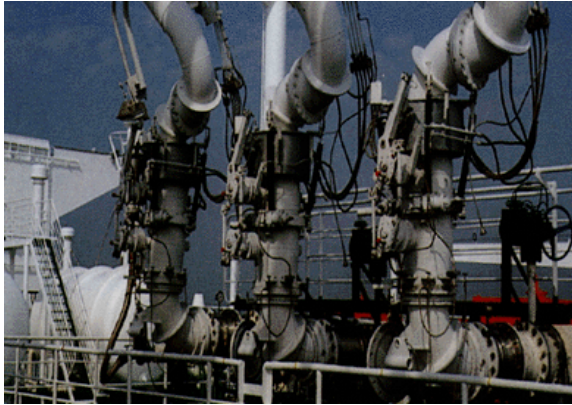
Photo- 18: LNG unloading arm
