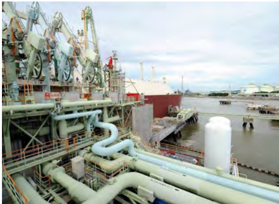
Photo- 1: LNG incoming piping
