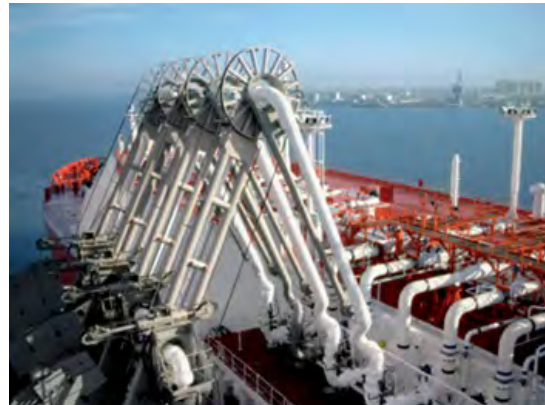
Photo- 13: LNG unloading arm
