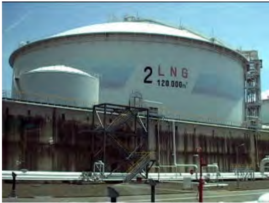
Photo- 24: Large LNG tank
