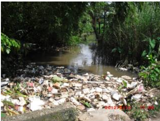
Kathwe 排水路 (No.2) 橋下面と水面間にクリアランスがないため、 浮遊ゴミが溜まっている
