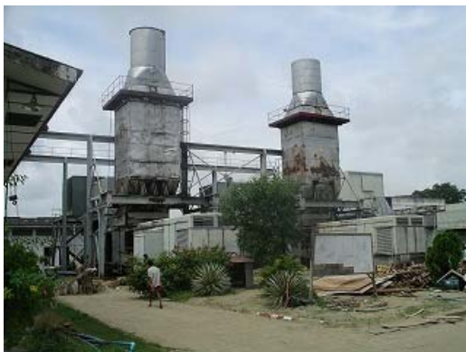
18.45MW ガスタービン発電設備（Ywama 発電所）
