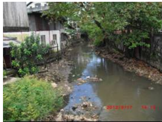
Shwehle 排水路 (No.20) 多くの堆積物 (シルト・土) が 排水路の流下能力を低減している。
