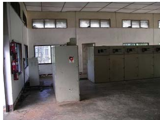
配電盤（Hluttaw 変電所）
