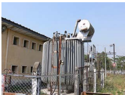
33/6.6kV 変圧器（Hluttaw 変電所）
