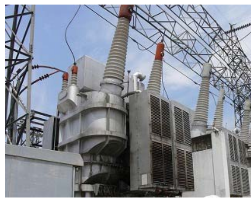
ガス遮断器（230kV Hlawgar 変電所）
