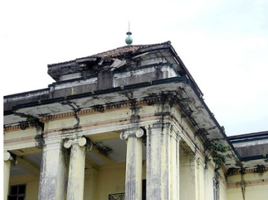
強風による屋根の破損
