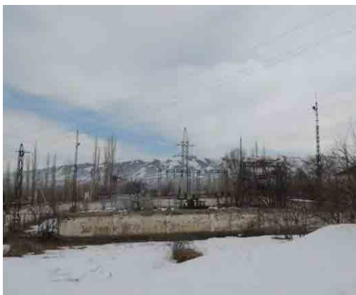
写真 6-2-70 35/10kV Belogorka 変電所
