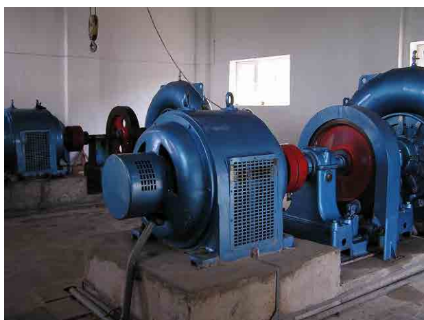
写真 6-2-110 自家発水力の水車・発電機
