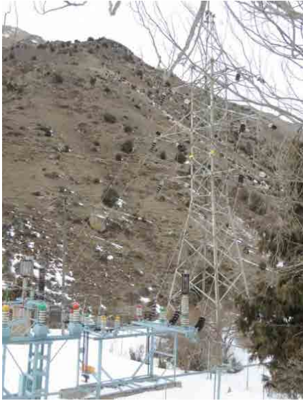
写真 6-2-77 35kV Sk-Bulak 変電所への配電線
