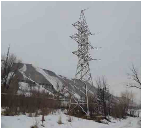
写真 6-2-69 35kV Belogorka 変電所への 配電線
