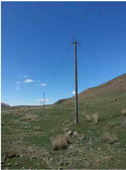
写真 6-2-99 取水地点付近の 10kV 配電線
