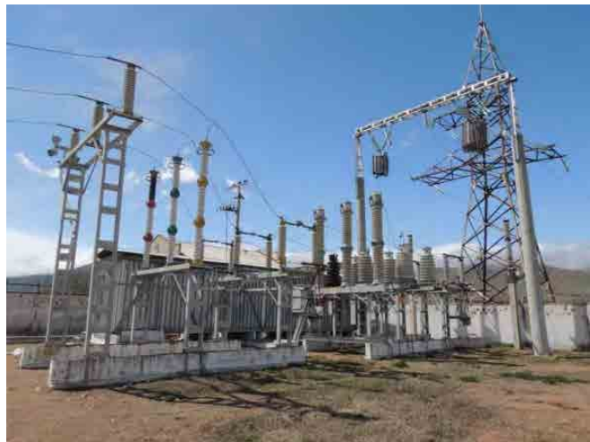
写真 6-2-100 110/35/10kV Shabdan 変電所
