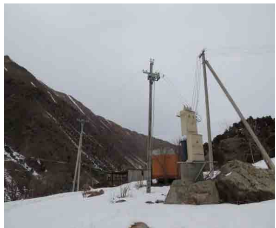
写真 6-2-80 取水地点付近の一般世帯 供給用 10/0.4kV 変圧器
