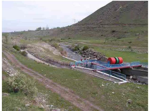
写真 6-2-102 Ak Suu-1 取水地点付近の 灌漑取水設備
