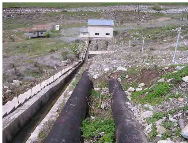
写真 6-2-109 自家発水力の水圧鉄管と 発電所建屋
