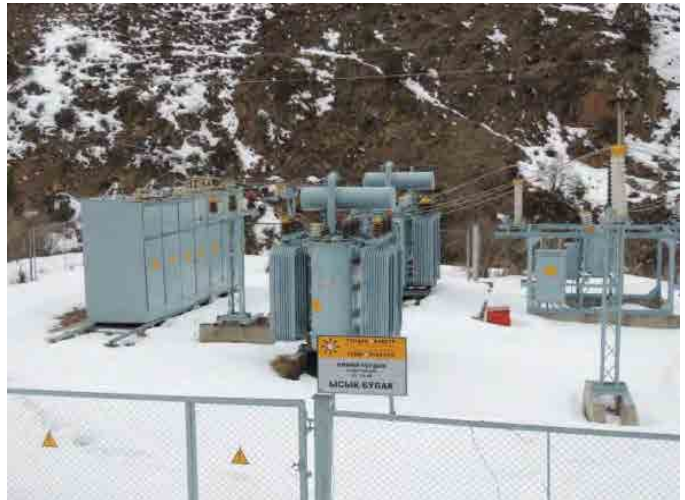
写真 6-2-78 35/10kV Sk-Bulak 変電所
