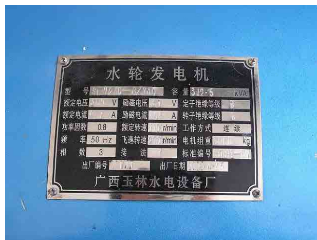
写真 6-2-111 自家発水力の発電機銘板
