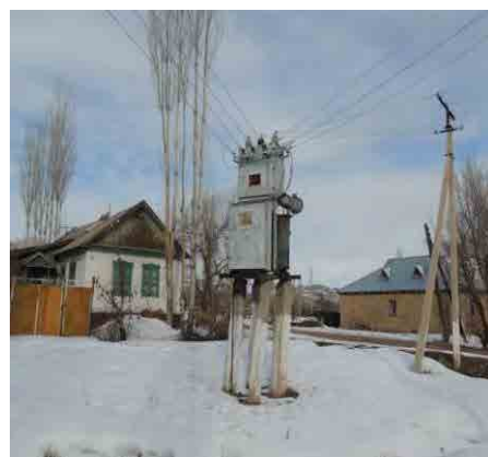
写真 6-2-71 Bululu 村で確認した 10/0.4kV 変圧器
