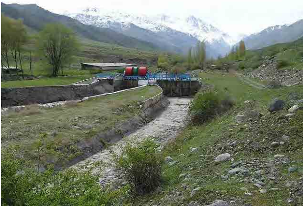
写真 6-2-101 Ak Suu-1 取水地点付近の 灌漑取水設備
