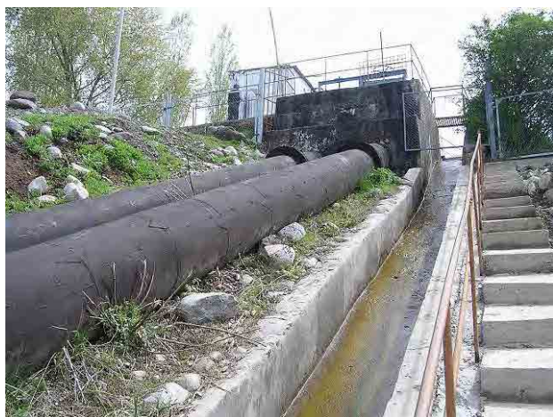
写真 6-2-108 自家発水力の水圧鉄管と水槽余水路
