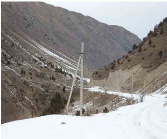
写真 6-2-79 Sk-Bulak 変電所から延びる 10kV 配電線
