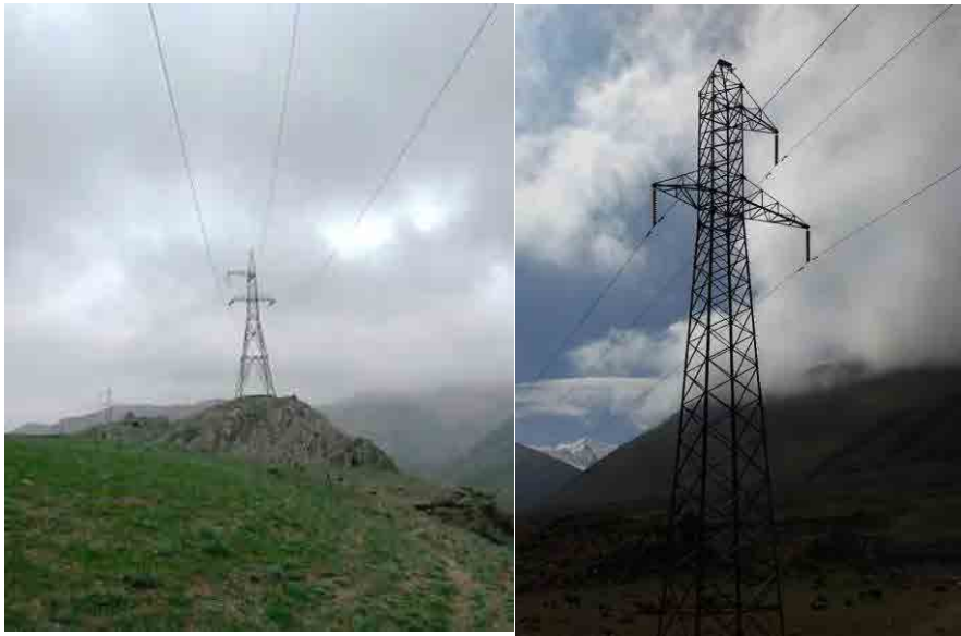
写真 6-2-98 220kV Bystrovka - Issyk-Kul 線
