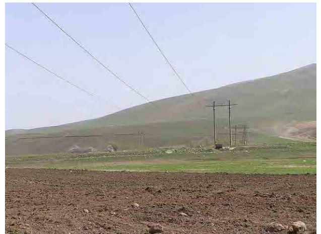
写真 6-2-92 発電所付近の 220kV 送電線
