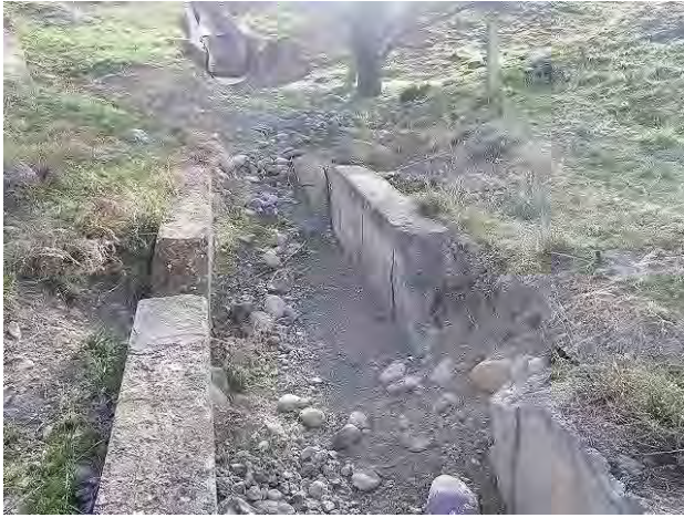
写真 6-2-56 水槽余水路損傷箇所
