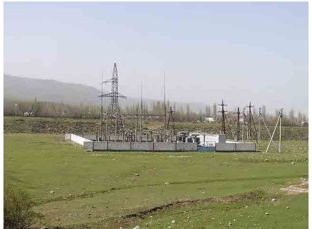
写真 6-2-90 35kV Shamsi 変電所
