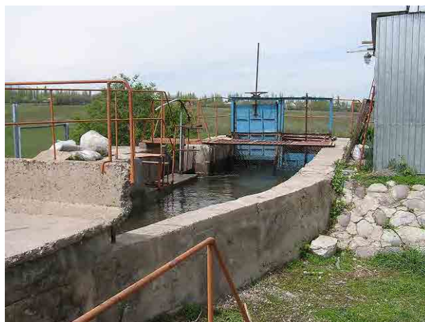
写真 6-2-107 自家発水力の水槽
