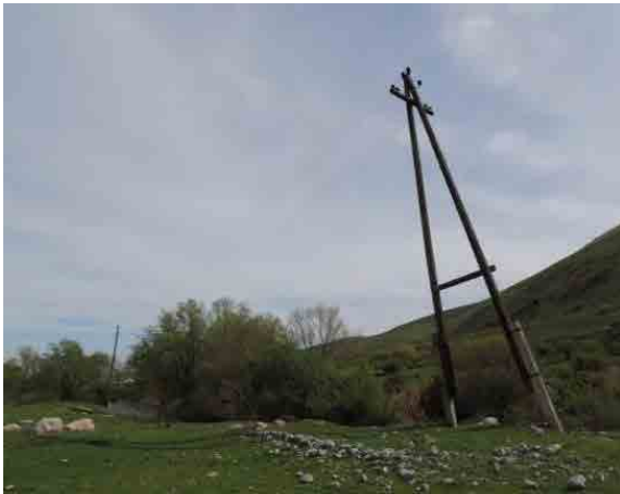
写真 6-2-46 既設 10kV 配電線の終端部
