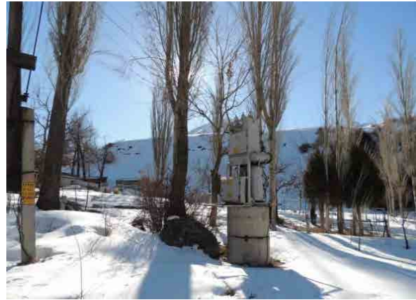
写真 6-2-52 発電所候補地点から約 2 km 下 付近の 10/0.4kV 変圧器
