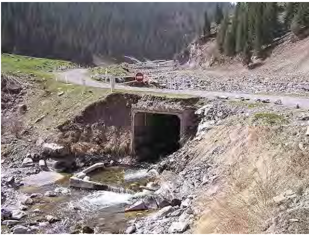
写真 6-2-1 A 地点道路閉鎖状況 Q=0.2\sim 0.3\text{ m}^3/\text{s} (目視)
