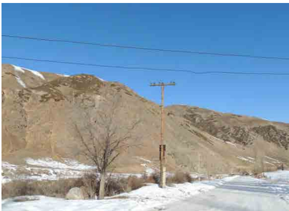
写真 6-2-53 周辺地域供給用 10kV 配電線
