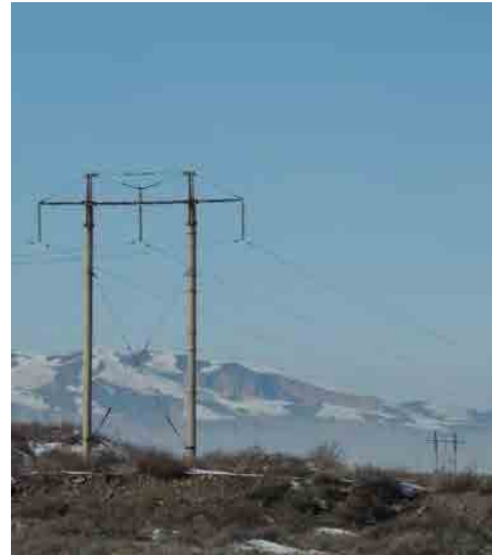
写真 6-2-17 220kV Ala-Archa - Bystrovka 線
