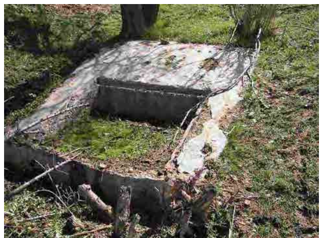
写真 6-2-25 水圧鉄管固定台
