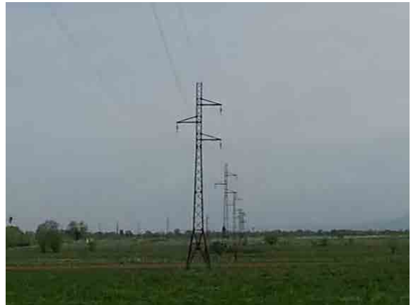
写真 6-2-45 35kV 配電線 (起終点変電所不明)
