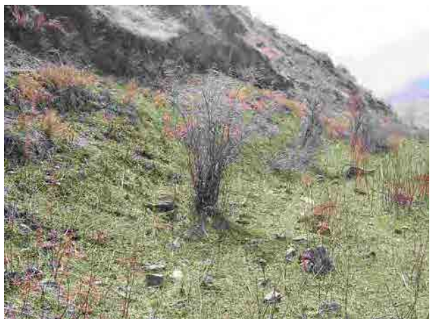
写真 6-2-35 斜面崩落で埋没した導水路区間
