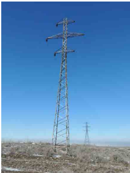
写真 6-2-18 35kV Koroi - Kegeti 線
