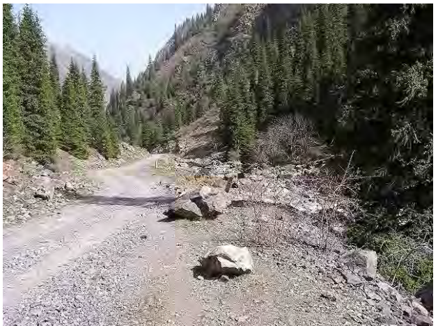
写真 6-2-6 A～B 地点間の道路上の落石
