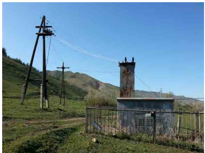
写真 6-2-19 発電所候補地点に最も近い 10/0.4kV 変圧器
