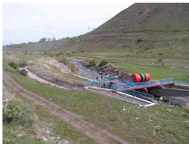
写真 5-3-2 Ak Suu 川灌漑取水設備
