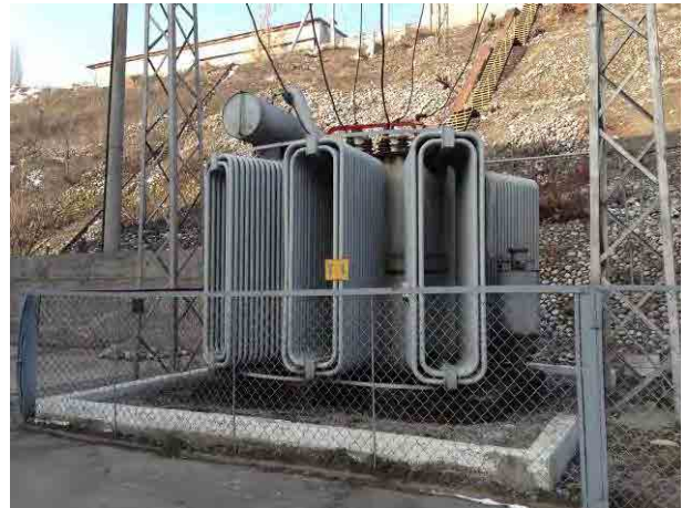
既存小水力発電所のトランス： オイルを定期的に取り替えているため、有害物質である PCB が高濃度で残存している可能性は低い。
