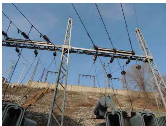
写真 5-7-19: 開閉所への接続の様子
