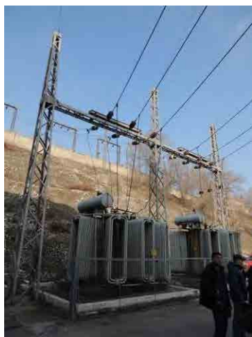
写真 5-7-17 : 発電所の昇圧用変圧器(6/35 kV)
