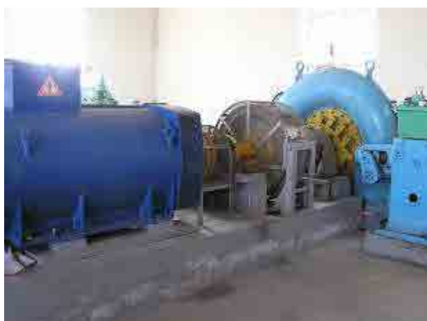
写真 5-7-5 : 発電所建屋内部 (水車・発電機)
