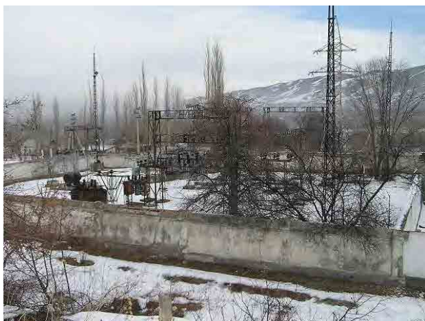
写真 5-7-11 : 発電所建屋に隣接する 35 kV 変電所
