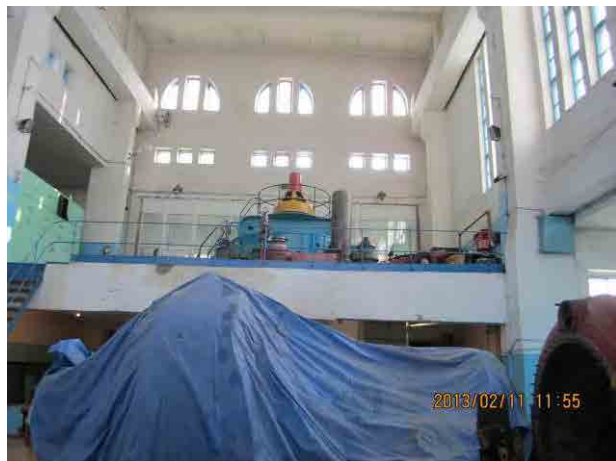
写真 5-7-15 : Lebedinovka 発電所建屋内部 奥 1 号機 (運転中)、手前 2 号機 (休止中)
