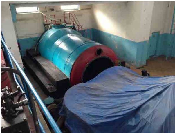
Lebedinovka： 修理できずに放置されている水車。リハビリティ実施時には、金属資源のリサイクルなど適切な配慮が必要。
