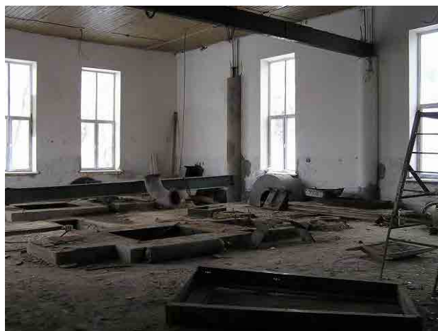
写真 5-7-10 : Sokuluk-2 発電所建屋内部
