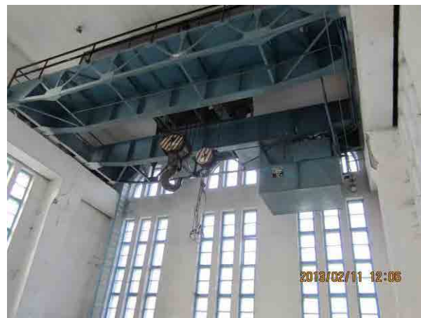
写真 5-7-16 : Lebedinovka 発電所 天井クレーン (2 号機上部)
