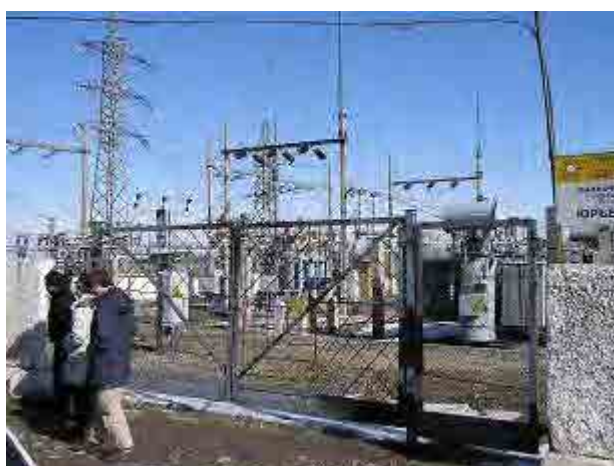
写真 5-7-6 : 隣接 35kV 変電所
