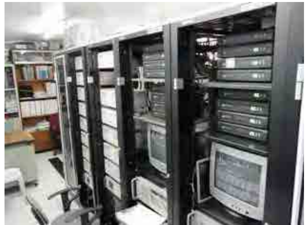
交通信号制御用ラック 2
