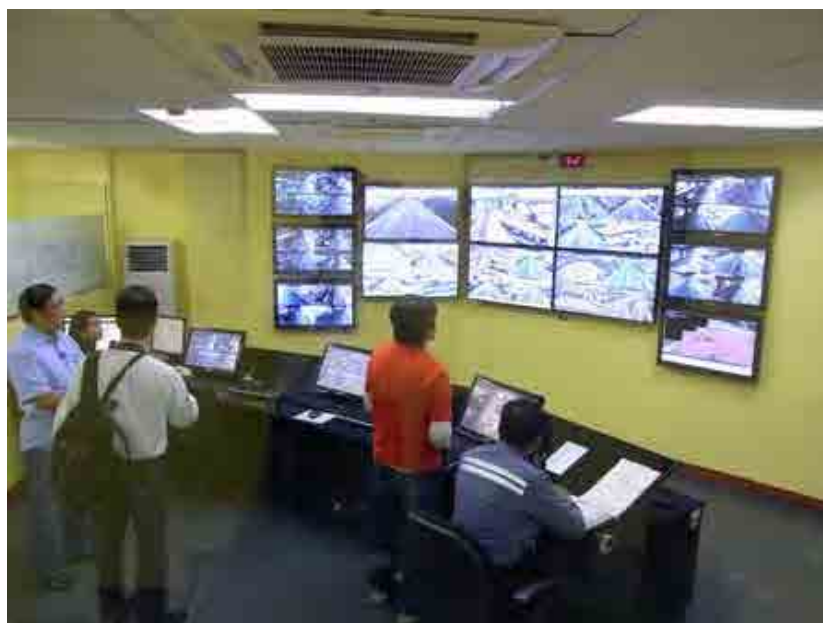
図 6.2-21 交通管制室 (SKYWAY O & M CORP.が運営)
