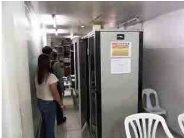
交通信号制御用ラック 1
