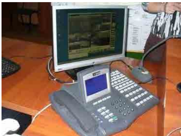
Tukimachi~Angren 間：SCADA と指令電話
