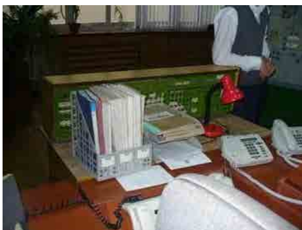
Tashkent~Djizak 間：操作スイッチ盤
