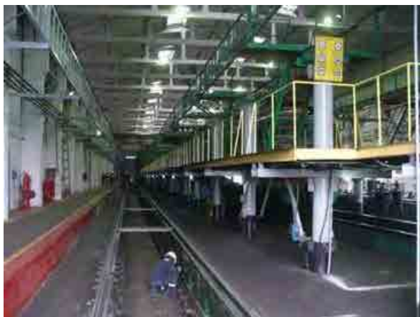
電気機関車の検修庫内部
