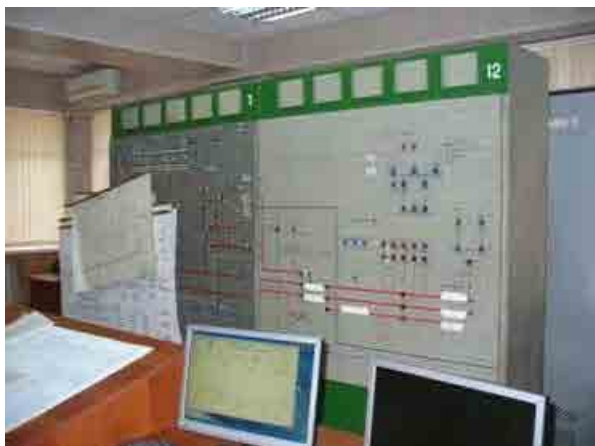
Tukimachi~Angren 間：系統表示盤
