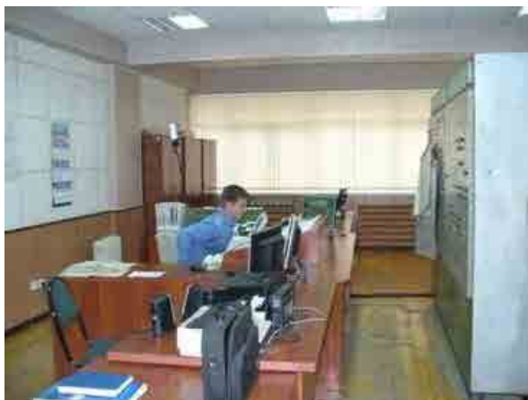
Tukimachi~Angren 間：操作卓
