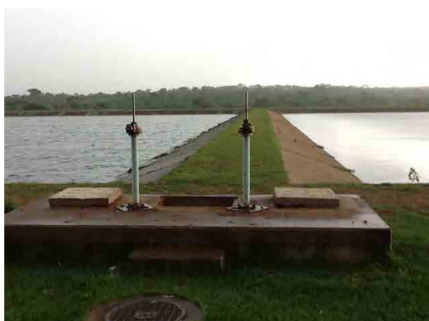
Lilongwe 市の下水処理場。第二次沈殿池。施設の老朽化と、鉄製部品の盗難目当てのバンダリズムで操業に困難があり、本来の施設の許容容量を生かされていない。
