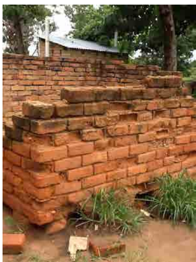
Nkhata-bayの小学校の小用トイレ
