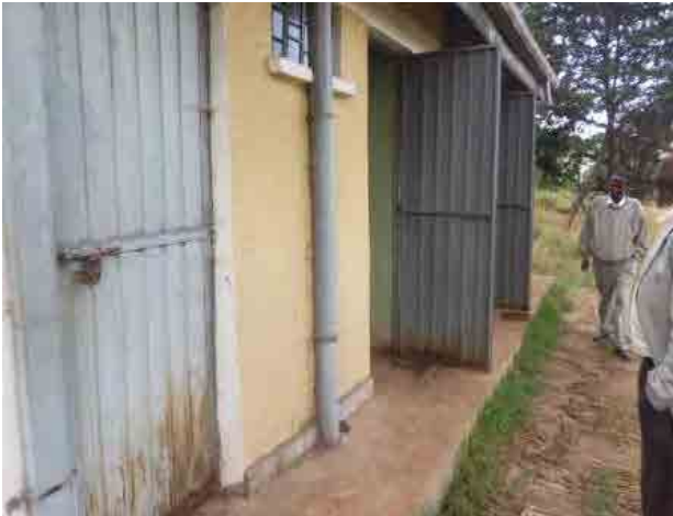
右上と同じトイレ。清掃は十分に行われていない。生徒数に対して圧倒的に数が不足している。
