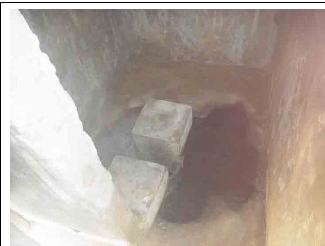
左トイレの内部。ピットラトリンであるが、便槽がほとんど満杯になっている。
