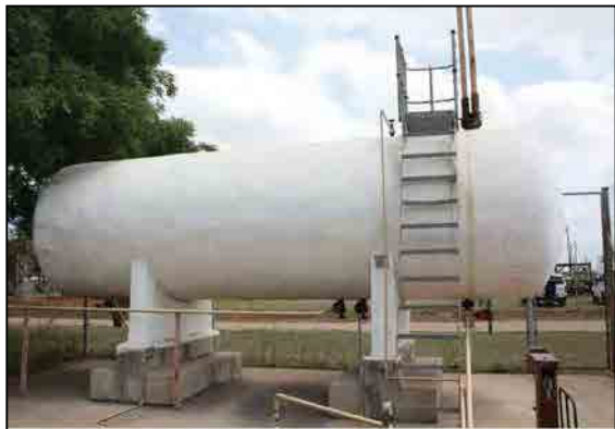
工場でのバルク使用 断熱被覆が施されている。
