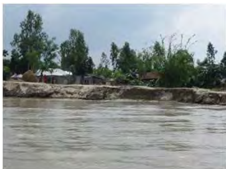
写真-9 Jamuna 川右岸の河岸侵食状況（1）
