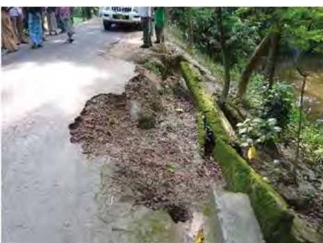
写真-15 Chandpur 堤防の被災状況
