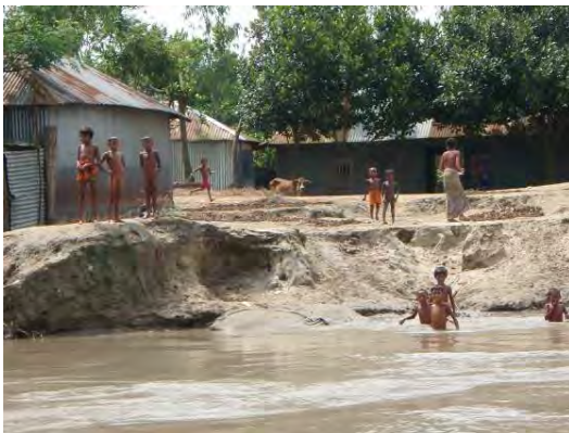
写真 河岸侵食状況 (1)
