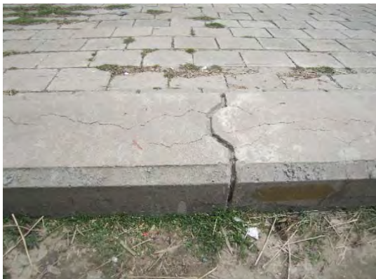
写真 護岸天端部のクラック
