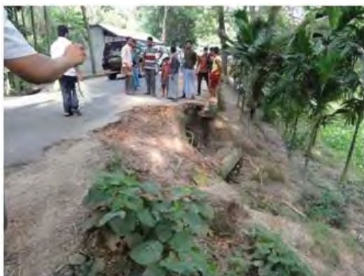
写真 修復を必要とする堤防区間
