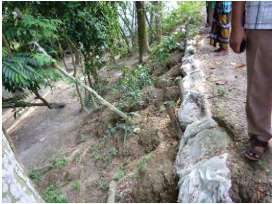
写真 堤防法面の崩壊
