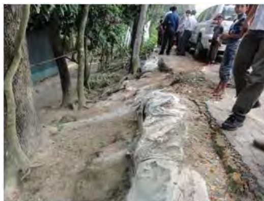
写真 修復を必要とする堤防区間
