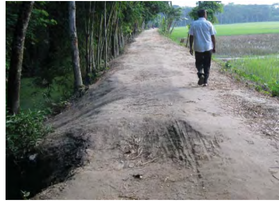
写真 堤防天端の損傷
