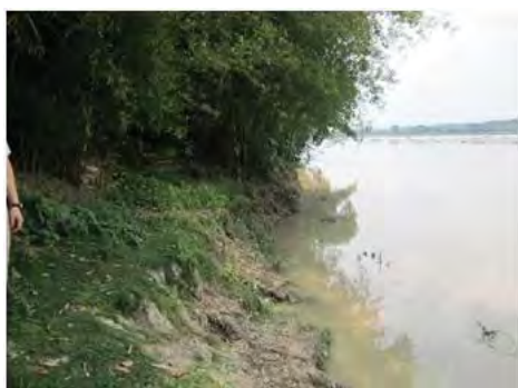
写真-11 Shitlakkya 川左岸の河岸侵食状況（1）
