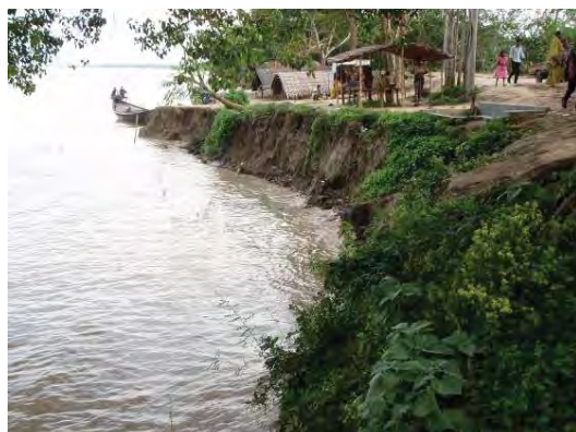
写真 河岸侵食状況
