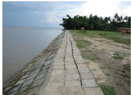
写真 護岸ブロックの不規則な隙間
