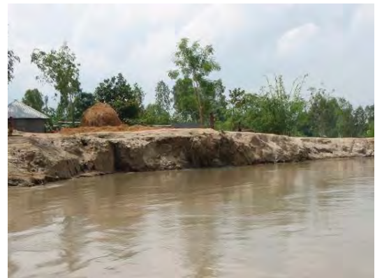
写真 河岸侵食状況 (2)
