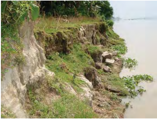
写真 河岸侵食状況 (3)
