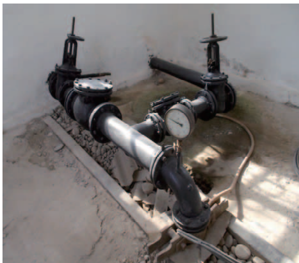
②稼働中のNO.4井戸は、砂吸出し対策として揚水量を抑えている。
