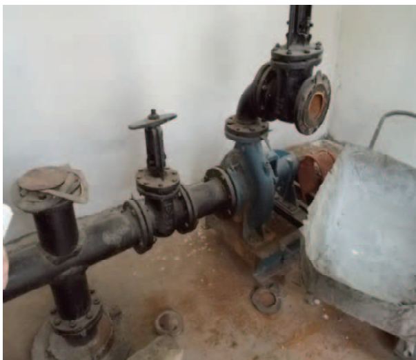
③NO.6横軸吸込ポンプを設置したが、設計ミスのため1度も稼働していない。
