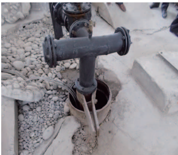
①休止中のNO.3の井戸は、砂吸出し現象により、地盤が沈下している。
