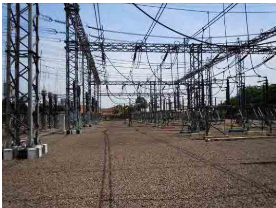
写真 Cikupa 変電所のスイッチヤード内
