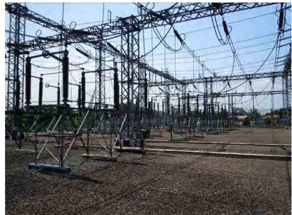
写真 Cikupa 変電所のスイッチヤード内
