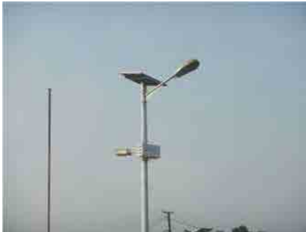
Eclairage routier (photo agrandie)
