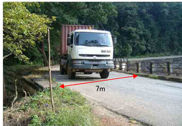
車道幅員が7mと狭く大型車の対面交通が不可能である。
