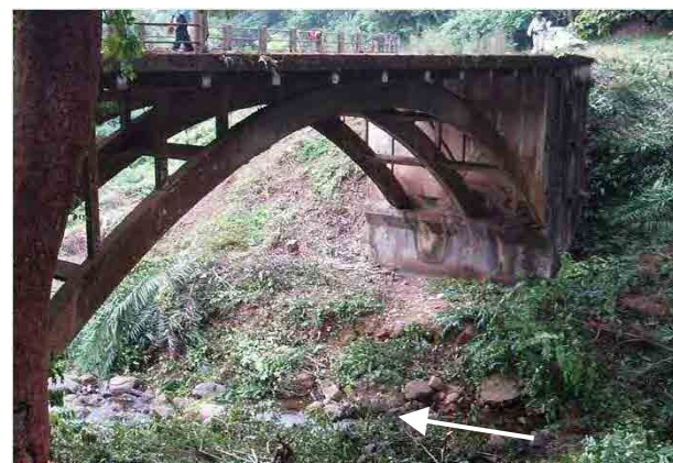
歩道がなく、さらに手摺が破壊されてしまったため、歩行者は10m以上下の谷底へ転落する恐れがある。
