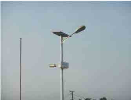
道路照明（拡大）
