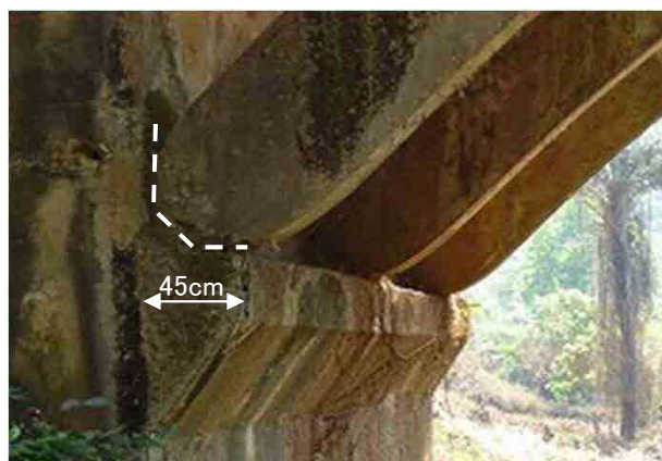
桁かけり長は本来81cm必要だが45cmしかなく、落橋の危険がある。
