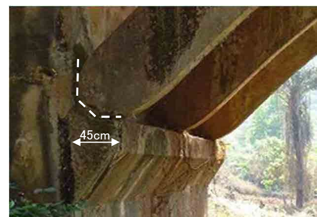
桁かけり長は本来81cm必要だが45cmしかなく、落橋の危険がある。
