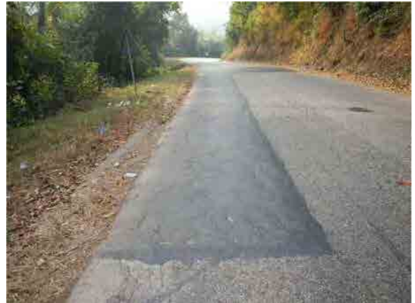
写真 2.2-1 カアカ橋のコヤ側の道路の補修跡
