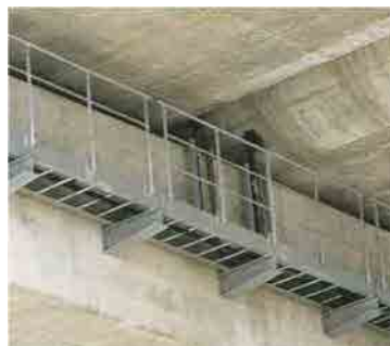
鋼製検査路の例
