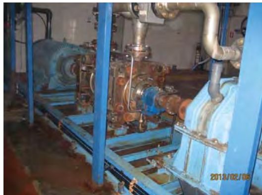
タービン式エネルギー回収装置付き高圧ポンプ
