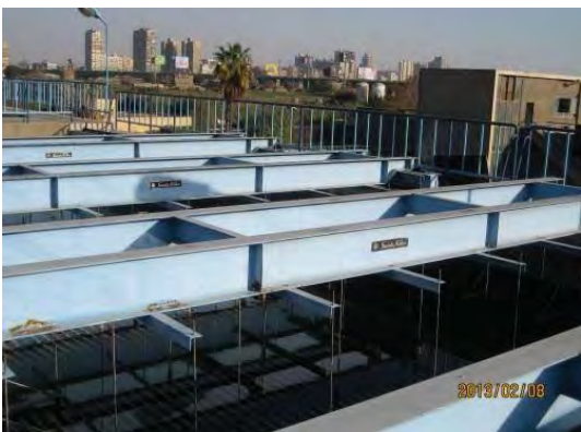
「傾斜板」式沈澱池(3号施設)
