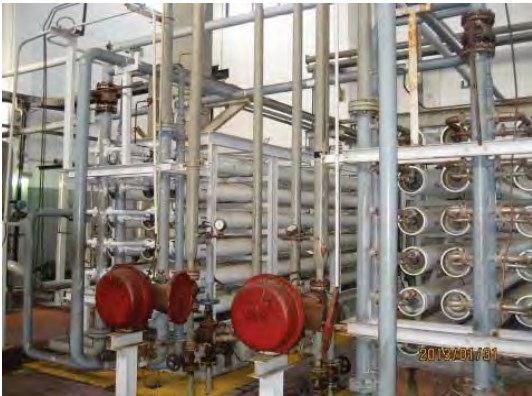
ROユニット(2,600m 3 /日/系列)
