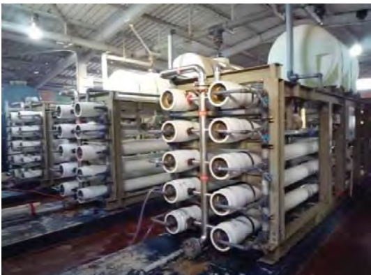
ROユニット(667m 3 /日 x 3系列)
