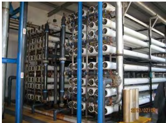
ROユニット(3,000m 3 /日/系列 x 2系列)
