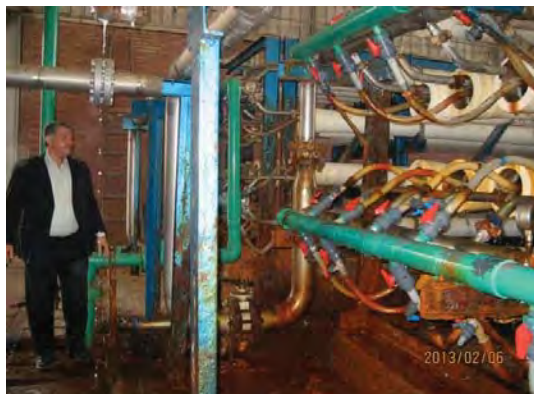
ROまわり配管。全体的に維持状態は良くない。
