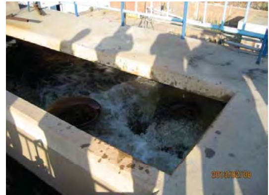
3号施設(35,000m 3 /日。1997年日本無償)取水井
