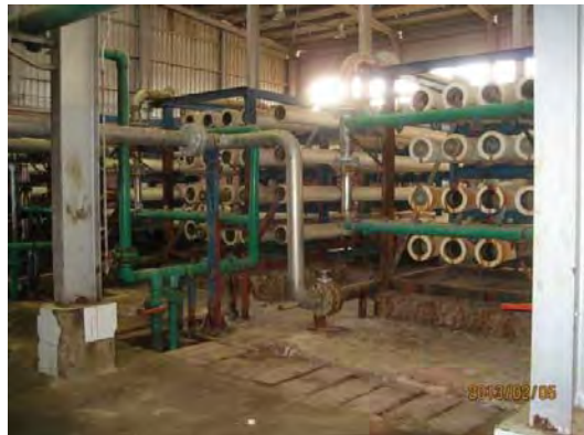
ROユニット(1,000m3/日/系列)
