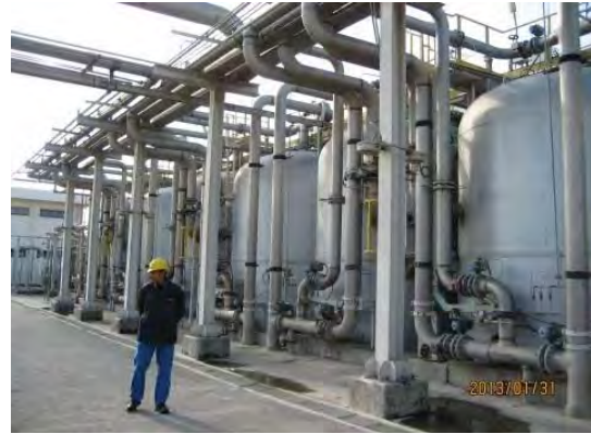
純水製造設備用前処理(砂ろ過器)
