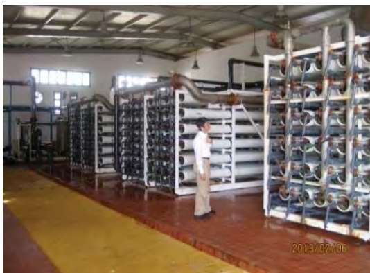
ROユニット(3,000m3/日x2系列 +2,000m3/日x2系列)
