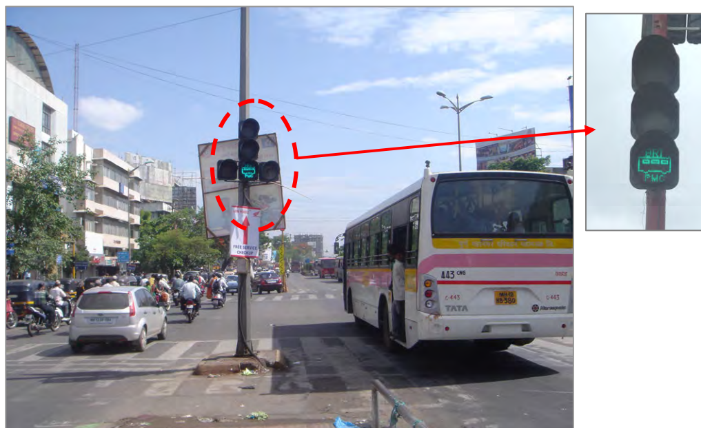
図 5.5.9 PMC の BRT ルート上に設置されている BRT 優先信号
