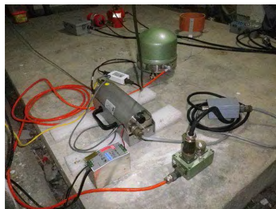
写真 - 4 : 同左観測所の地下室。広帯域地震計 (中央) と強震計 (後方)。手前は CTBTO の機材。建物の地下室に設置されている。本プロジェクトにより、既存強震計を計測震度機能を有する強震計に置き換える。
