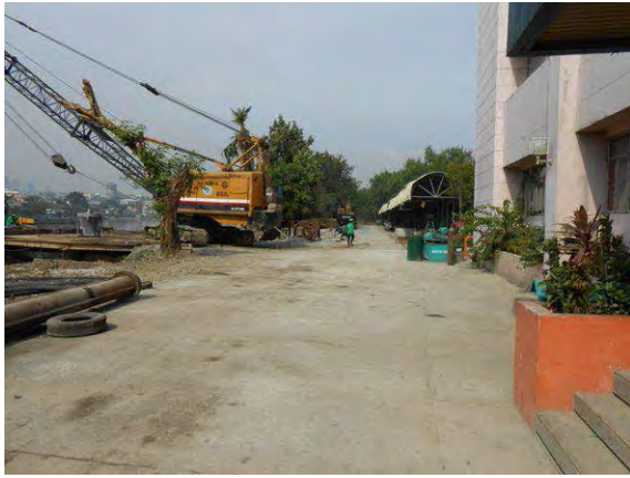
写真 - 9 : マニラ首都圏パッシング市内、パッシング川に面した DPWH 治水砂防技術センター (FCSEC)。ここに排水ポンプ車を搬入し、初期操作指導および引渡しを行う。
