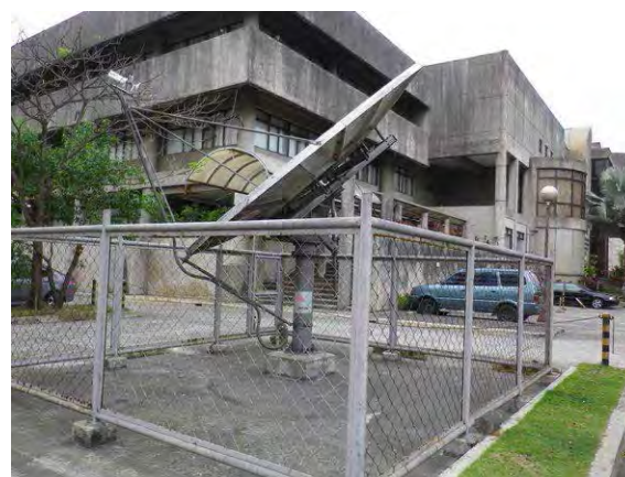
写真 - 2 : PHIVOLCS 本部棟と敷地内に設置された ABS 衛星通信用アンテナ (本プロジェクトでも利用する)。IP-Star 用アンテナは建物屋上に設置されている。本プロジェクトでは、IP-Star の冗長性を確保するため、IP-Star 用衛星通信機材を 1 セット調達する。
