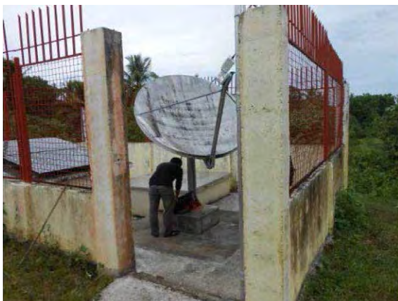
写真 - 5 : ヴィラック無人地震観測所 (広帯域強震計対象サイト)。衛星通信設備、広帯域地震計、強震計、太陽光発電設備を有する。ケアテイカーの定期的な維持管理により、管理状況は良好である。
