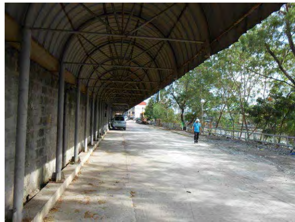
写真 - 10 : FCSEC 棟横の駐車スペース。排水ポンプ車の搬入後の保管予定場所。フェンス等で囲われた敷地ではないため、引渡までの機材保管期間のセキュリティ対策が必要。
