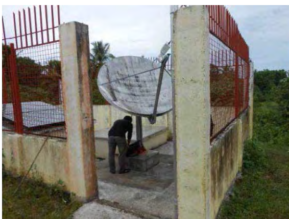
写真 - 5 : ヴィラック無人地震観測所 (広帯域強震計対象サイト)。衛星通信設備、広帯域地震計、強震計、太陽光発電設備を有する。ケアテイカーの定期的な維持管理により、管理状況は良好である。
