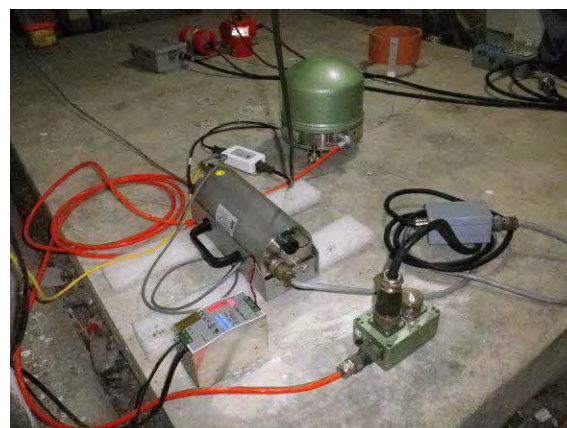
写真 - 4 : 同左観測所の地下室。広帯域地震計 (中央) と強震計 (後方)。手前は CTBTO の機材。建物の地下室に設置されている。本プロジェクトにより、既存強震計を計測震度機能を有する強震計に置き換える。
