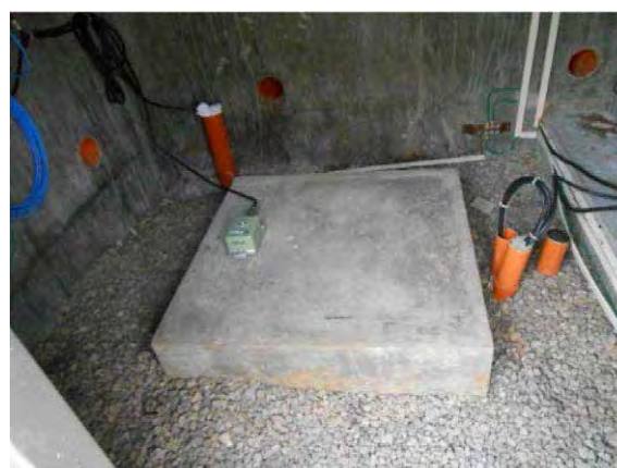
写真 - 6 : ヴィラック観測所内、地震計小屋。既設の地震計小屋、設備共、良好な管理状況である。既存コンクリート基礎上に広帯域強震計を設置する。
