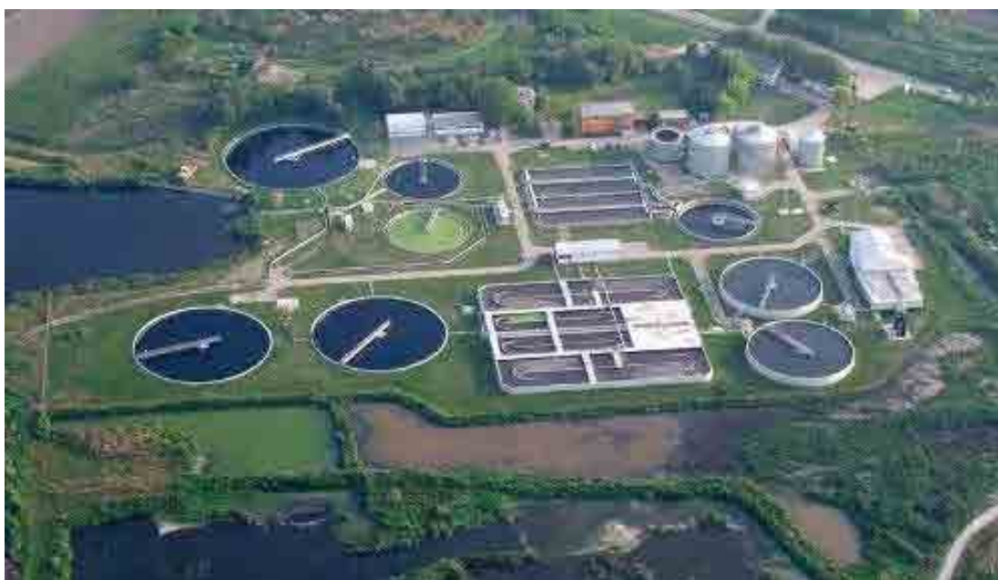
図 2.1 Subotica 下水処理場の全景
