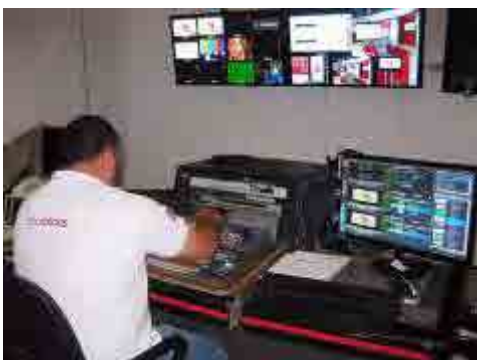
写真-7：映像調整室の様子。映像切替え用スイッチャーを設置している。
