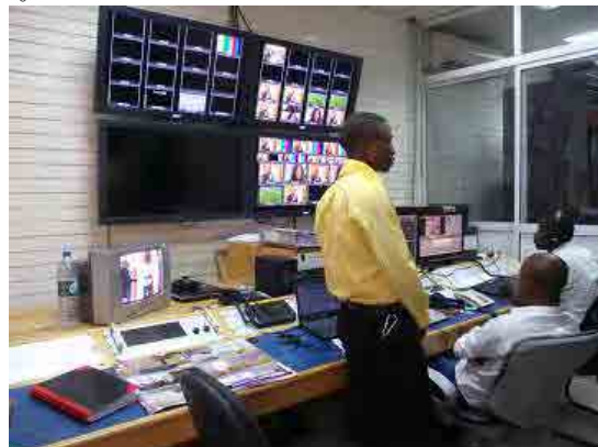
写真-6: マスターコントロールルーム (MCR)。ここから番組が送出される。
