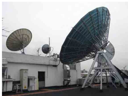
写真-2：送信所との放送信号通信用の送信機
