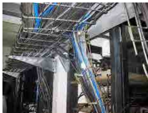
写真-10：主調整室の電線類は束ねてラック上部の電線用通路に通している。
