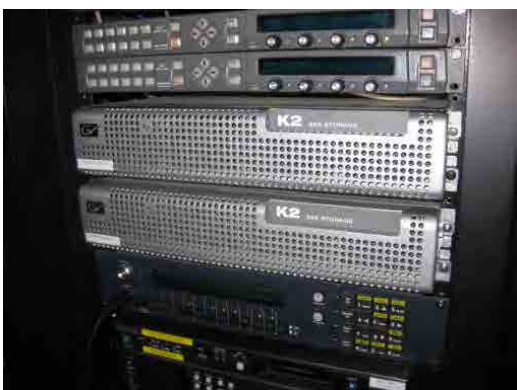
写真-11：放送予定の番組を管理しているサーバー。
