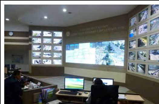
交通管制センター
