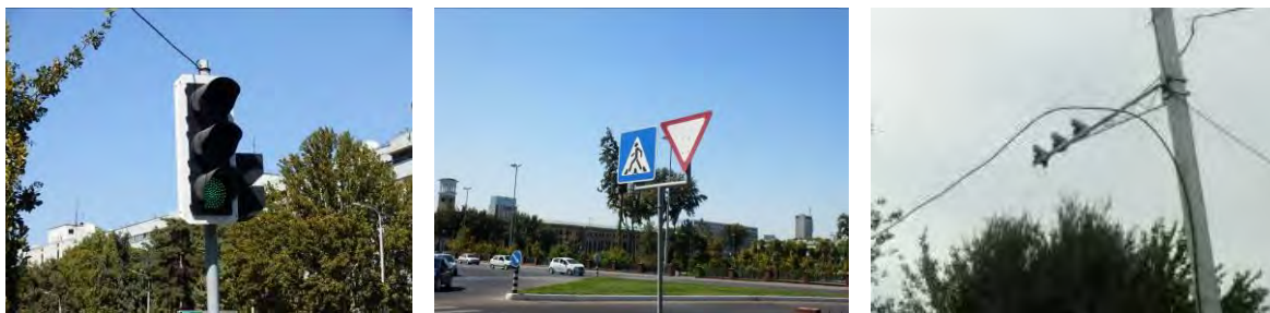
図 7-1 国道付帯設備（出典:調査団現地調査結果）
