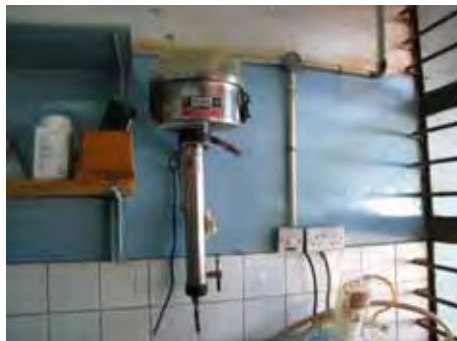
蒸留器 老朽化・故障している。稼働中の機材はない。
