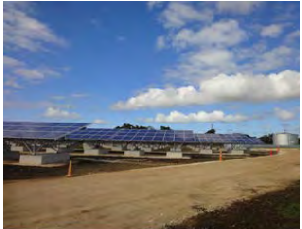
既設の太陽光発電設備(1.3 MWp)
