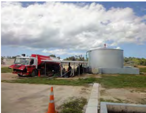
ポプア発電所の燃料(軽油)貯蔵設備
