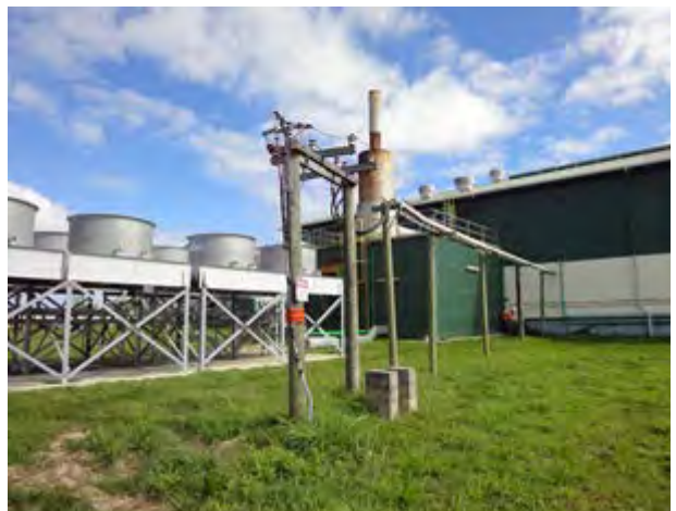
パイニ系統の引出線(海底ケーブル)
