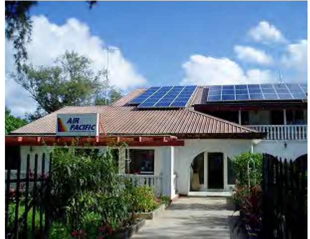
分散型太陽光発電設備の導入状況
