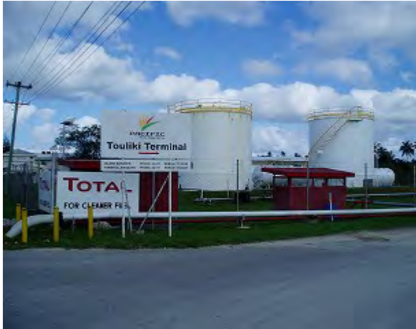
トンガタプ島の石油備蓄設備
