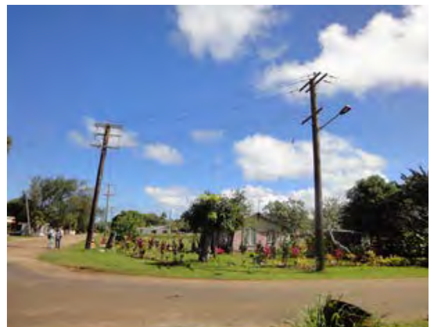
風力発電要請サイトへの高圧(11 kV)配電線の延伸起点
