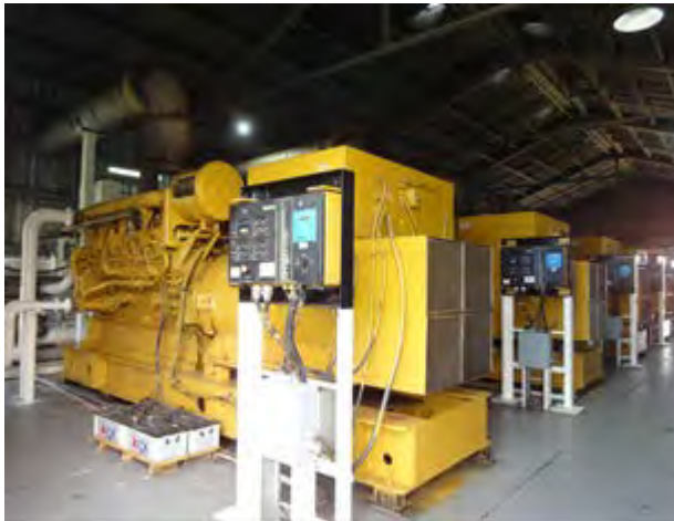
負荷追従用発電設備(運転台数制御)
