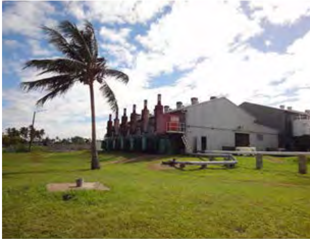
ポプア発電所
