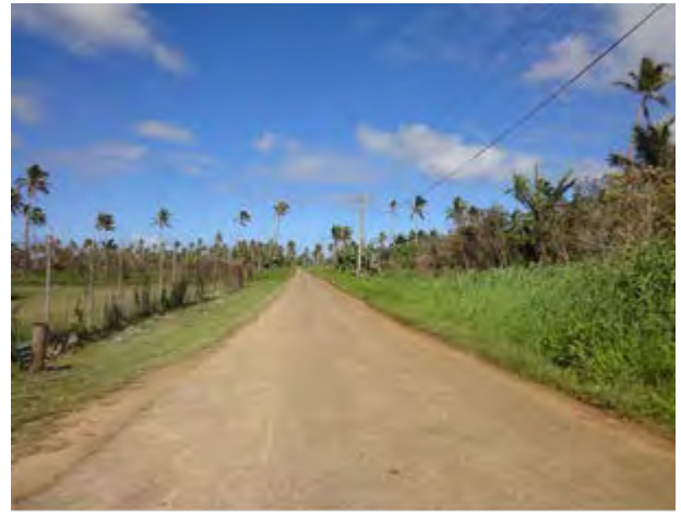
太陽光発電要請サイト近傍の高圧(11 kV)配電線
