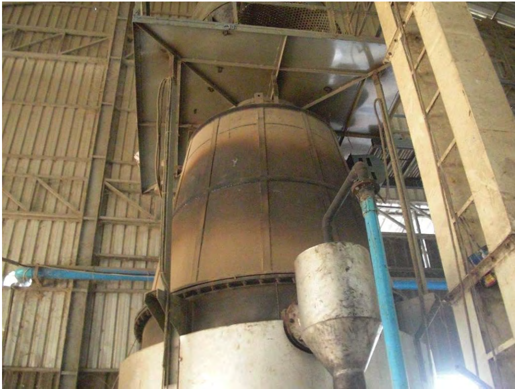
図表21 籾殻ガス化発電設備（反応炉）
