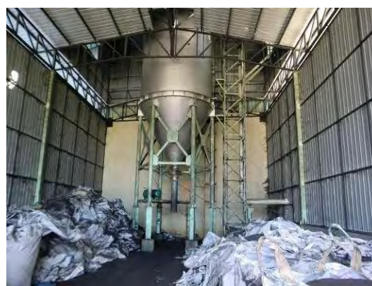
籾殻焼却灰のパッキングプラント
