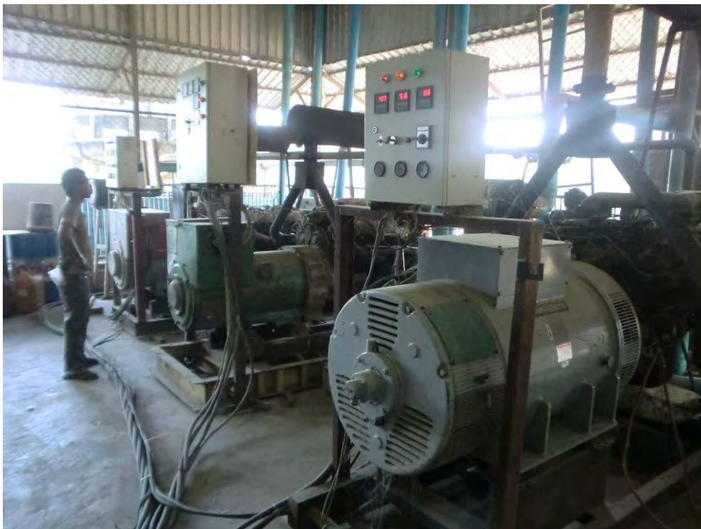
図表22 籾殻ガス化発電設備（ガスエンジン）
