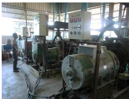
籾殻ガス化発電設備（ガスエンジン）
