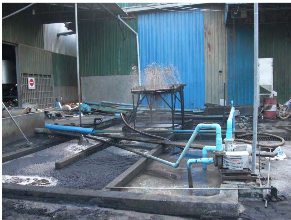
図表25 籾殻ガス化発電設備の排水処理装置
