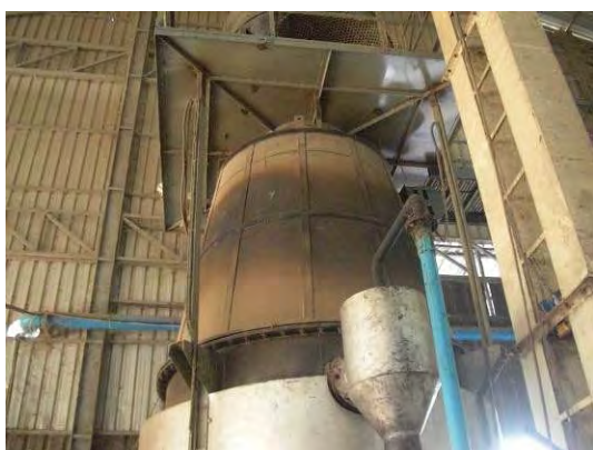
籾殻ガス化発電設備（反応炉）
