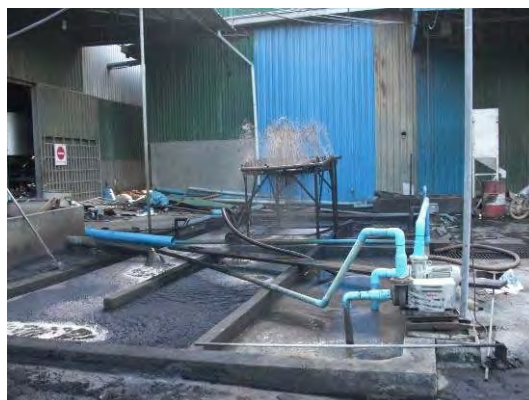
籾殻ガス化発電設備の排水処理装置
