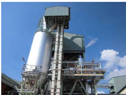
Angkor 籾殻発電所全景
