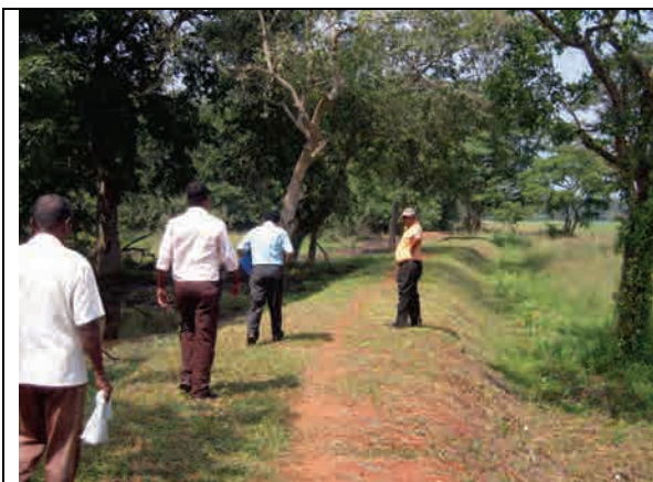
ナーナッダン郡チェッディヤーマガン カッダ イアダンパン村の洪水防御堤防の瑕疵検査
