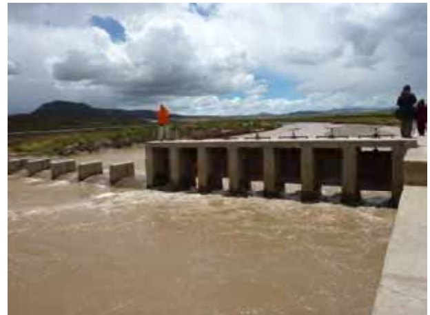
ラパス県内 高地高原地域の取水施設
