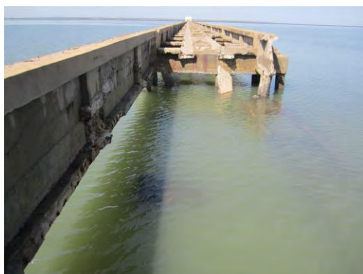
マプト火力旧石炭火力用取水管橋(一部欠損)
