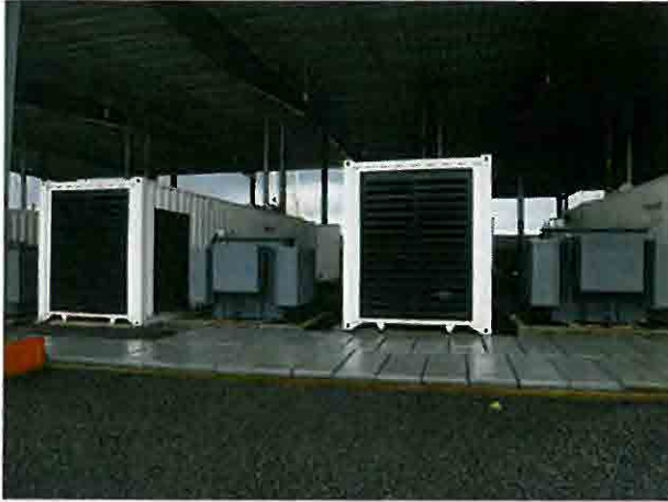
電力設備の現況
