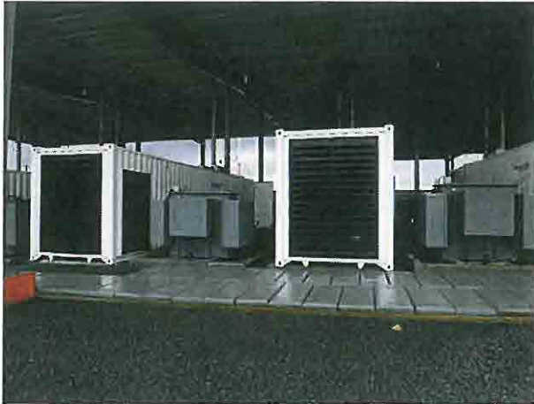
電力設備の現況
