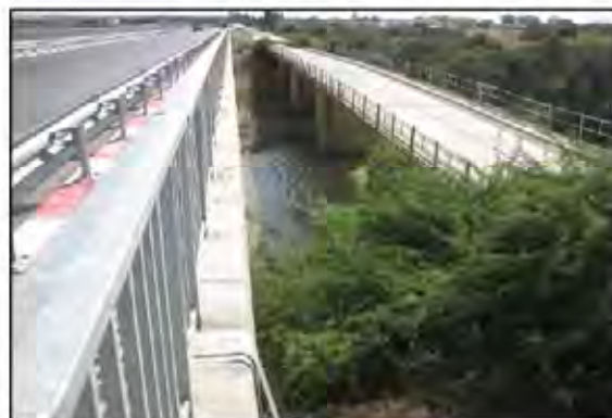
Figure 6.3-3 État actuel de l'ancien pont de Tobias (8.2012)
