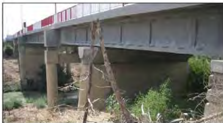
Figure 6.3-10 État actuel du pont de Jedeida sur GP7 (8.2012)
