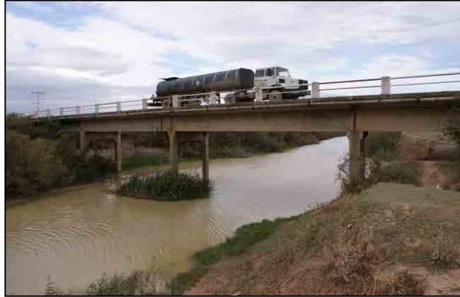
Figure 6.3-5 État actuel du Pont GP8 sur l'oued Mejerda (8.2012)
