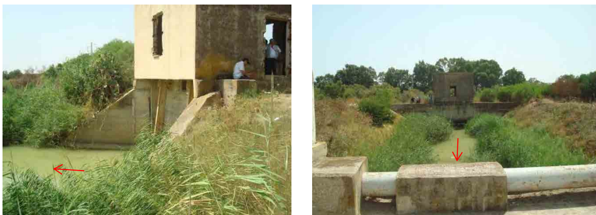
Figure 3-20 Le point de confluence du canal de restitution du bassin de retardement d'El-Mabtouh avec l'oued Mejerda, et la vanne
